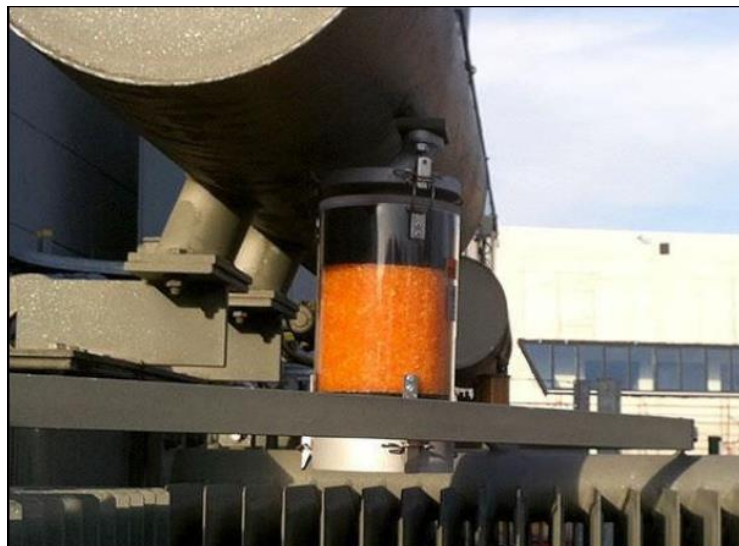
Figura 11: Secador de Silica Gel montado en un Transformador.
