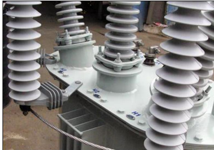
Figura 8: Transformador con Pararrayos Montados.
