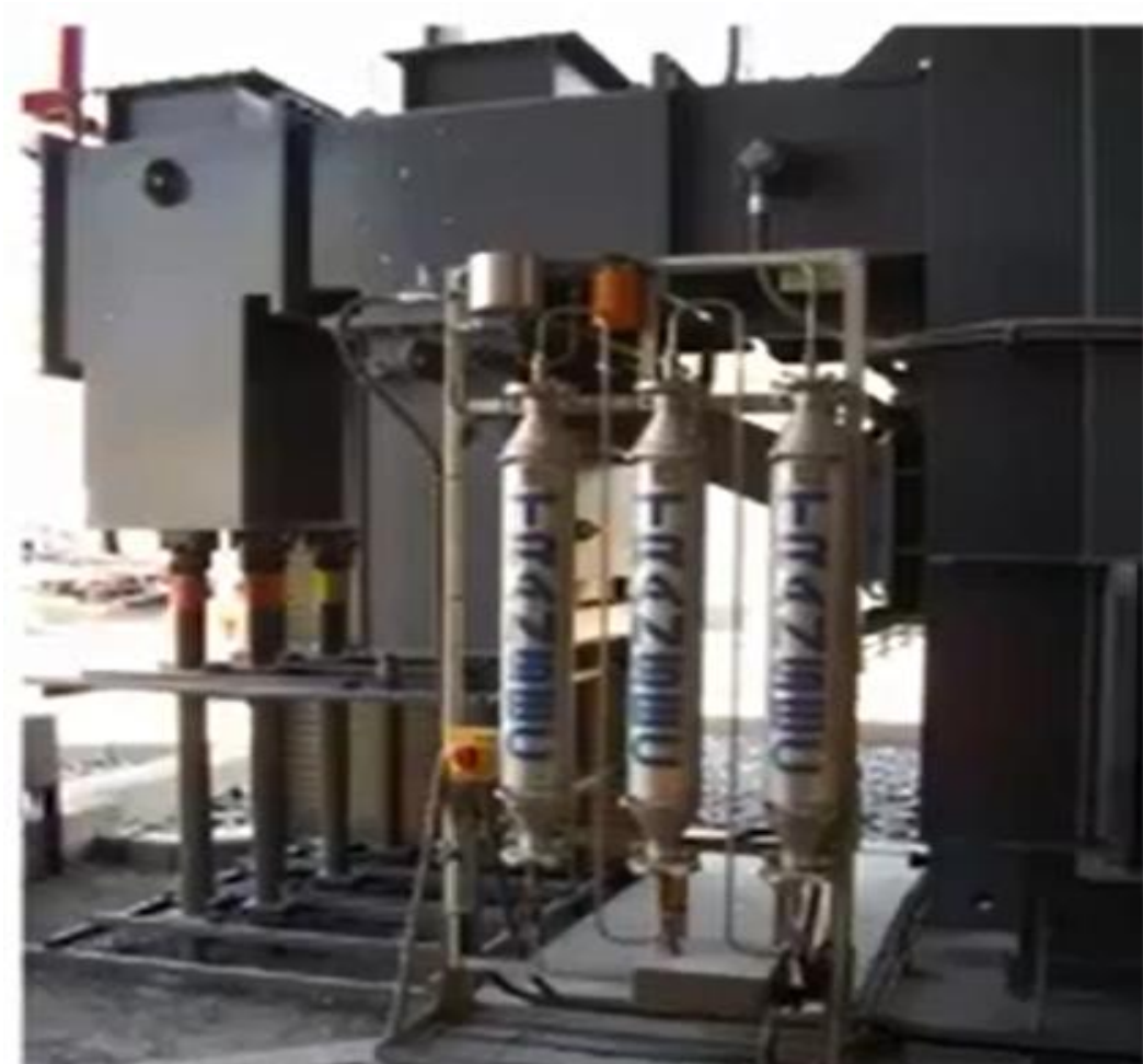
Figura 34: Equipo TRANSEC instalado en el transformador de potencia.
