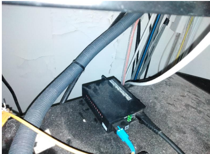
Figura 7 Notorio caso de falta en mantenimiento Fuente: Fuente Propia
