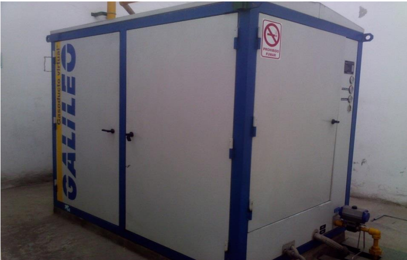
Imagen 21: Planta Reguladora de Presión ( ver Anexo 14)
