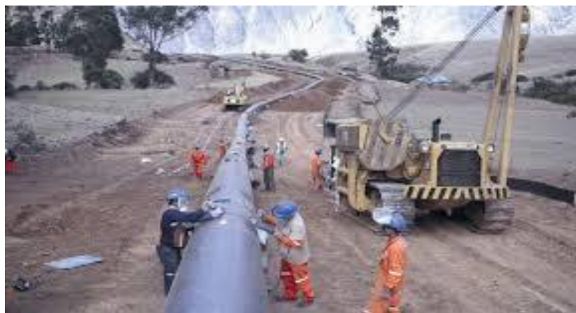
Imagen 2: Ducto para transporte de Gas Natural
