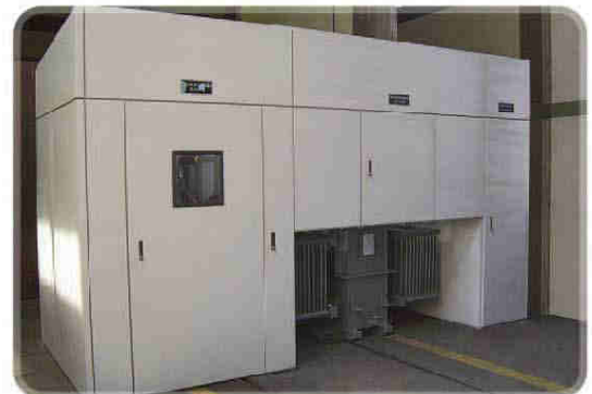
Subestación Metal Enclosed 500 KVA 22.9/0.48 kV Minera Sillustani - Puno
