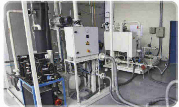
Máquinas de vacío y tratamiento de aceite
