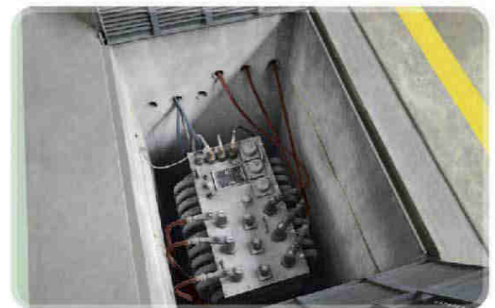
Transformador tipo bóveda (SPU) 160 KVA 10/0.23 kV Delcrosa - Lima
