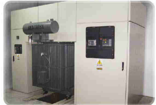
Subestación Metal Enclosed 1250 KVA 10/0.23 kV Petroperú - Lima
