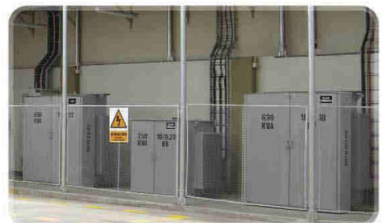
Subestación tipo pedestal (PMT) 630 KVA 10/0.23 kV - 250 KVA 10/0.23 kV - 630 KVA 10/0.80 kV Delcrosa - Lima
