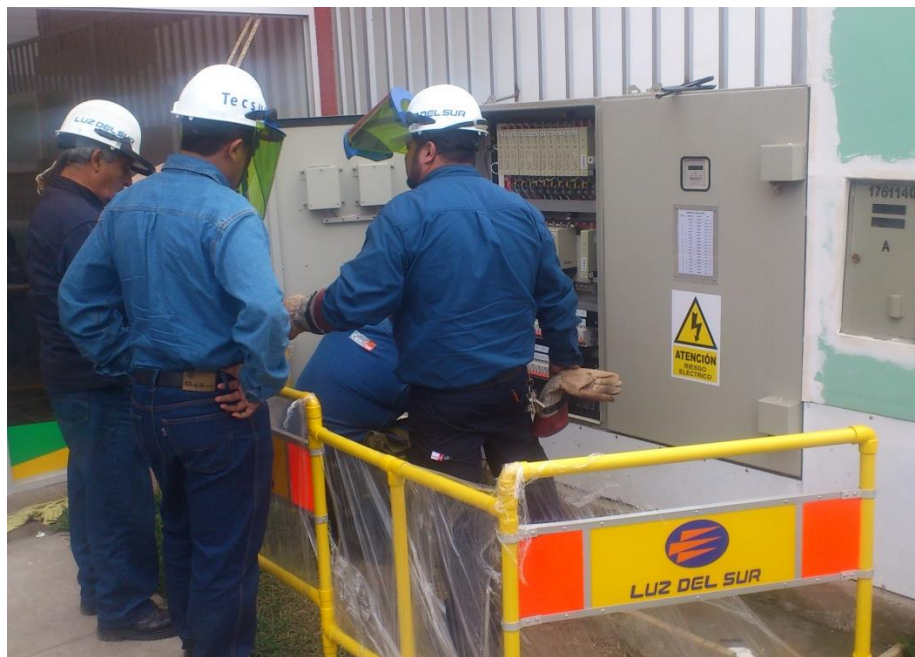
Figura 50: Verificación y puesta en servicio de los concentradores
