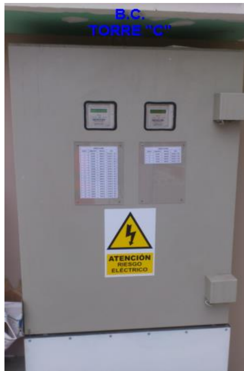
Figura 45: Estado final banco de concentradores Torre C
