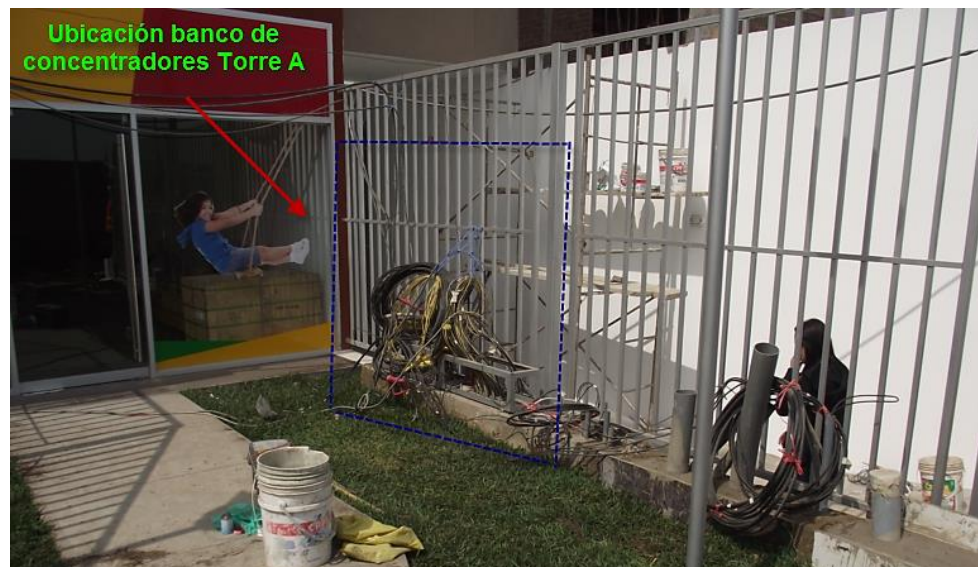
Figura 37: Estado inicial banco de concentradores Torre A
