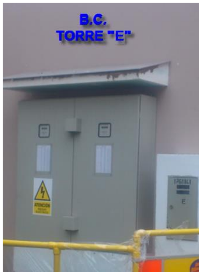
Figura 47: Estado final banco de concentradores Torre E
