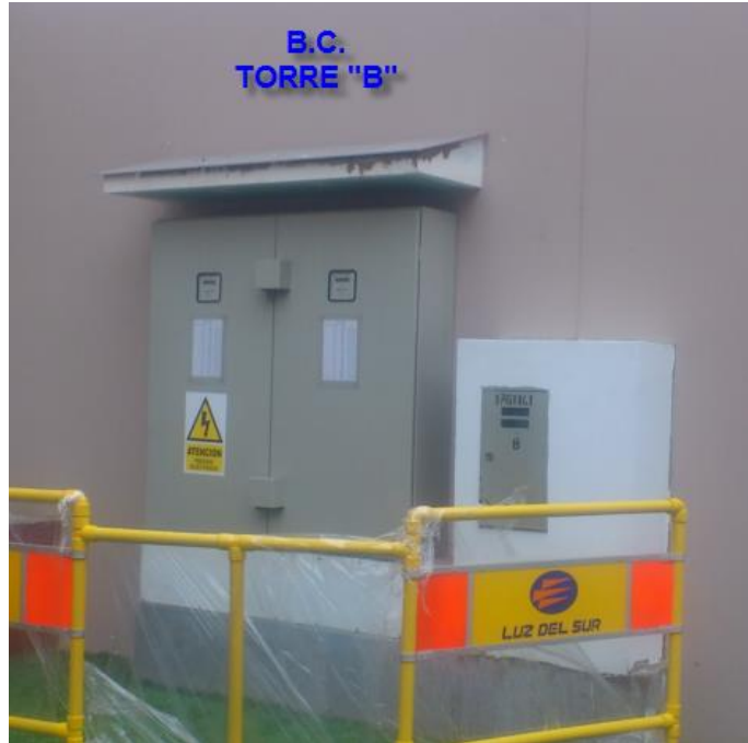
Figura 44: Estado final banco de concentradores Torre B
