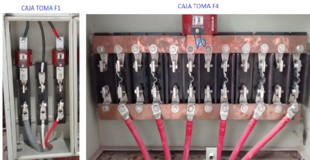
Figura 9: Interior de Caja toma F1 y F4
