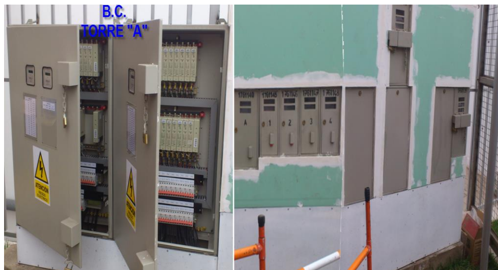
Figura 43: Estado final banco de concentradores Torre A
