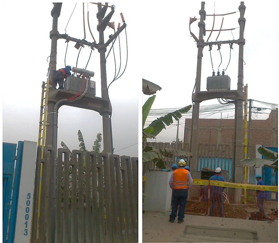
Figura 51: Subestación Aérea Biposte N° 10961A
