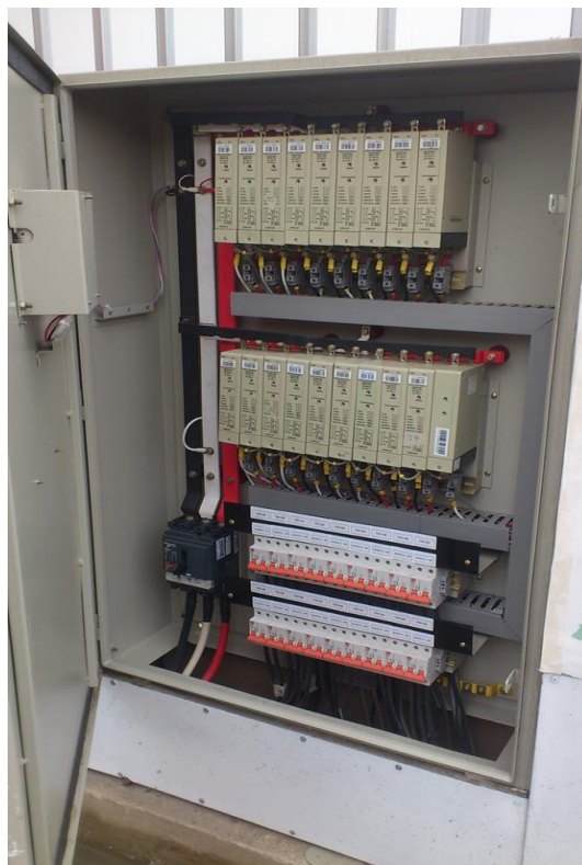
Figura 48: Equipamiento de los concentradores
