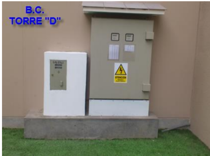
Figura 46: Estado final banco de concentradores Torre D
