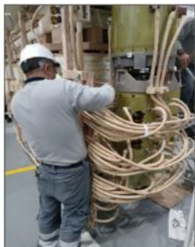
Foto 17: Conexión del OLTC suministrado por Hitachi Energy.
