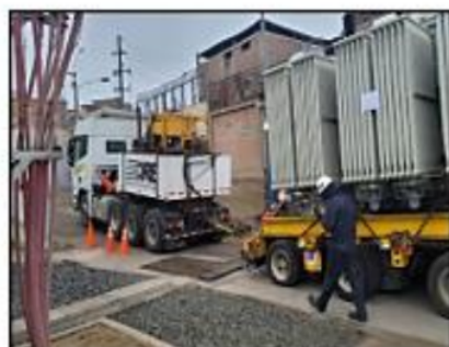
Foto 03: Ingreso del transformador en la SET Villa María
