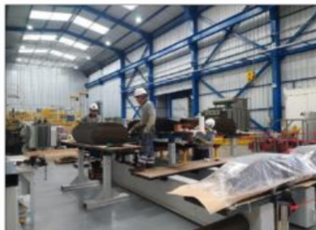
Foto 06: Mantenimiento de las láminas del núcleo.
