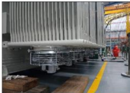
Foto 26: Vista de sistema de ventiladores vertical.
