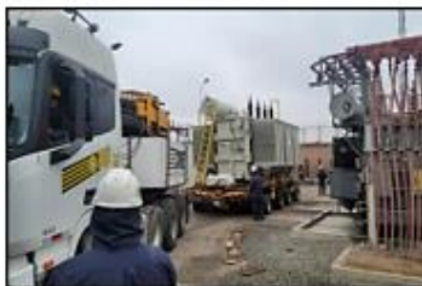
Foto 04: Ubicación del transformador en la zona de descarga autorizada por LDS.
