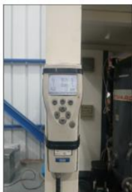
Foto 35: Tratamiento de aceite por termovacío y lectura de contenido de agua (< 20 ppm)
