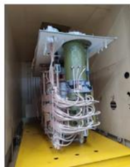
Foto 21: Ingreso de parte activa a horno autoclave para proceso de calentamiento, secado y vacío.
