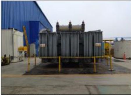
Foto 01: Recepción del transformador en planta Hitachi Energy.
