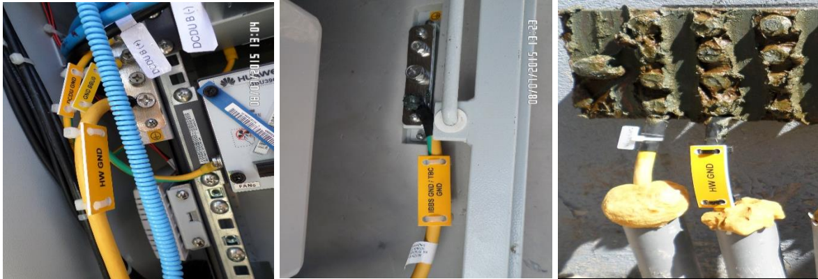
FIGURA 3-83: Etiquetado en las barras de aterramiento, Site Santa Teresa
