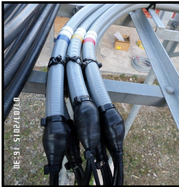
FIGURA 3-78: Cable de energía y FO
