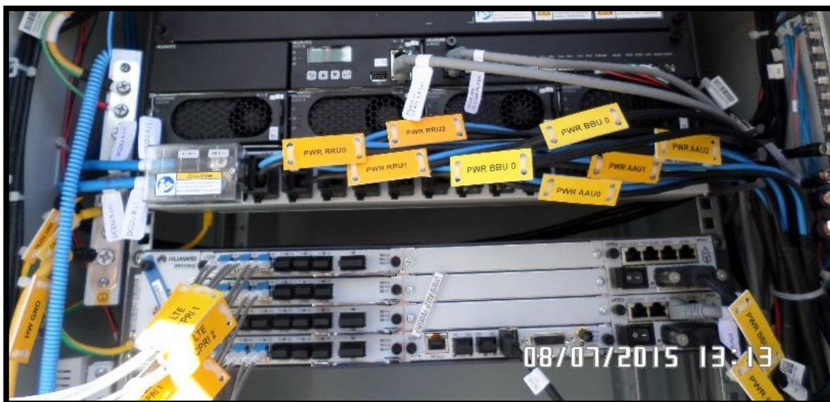
FIGURA 3-10: Módulos Rectificadores, Site Santa Teresa
