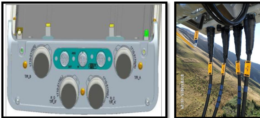
FIGURA 3-58: Conectores DIN (Jumpers de la Antena), Site Santa Teresa
