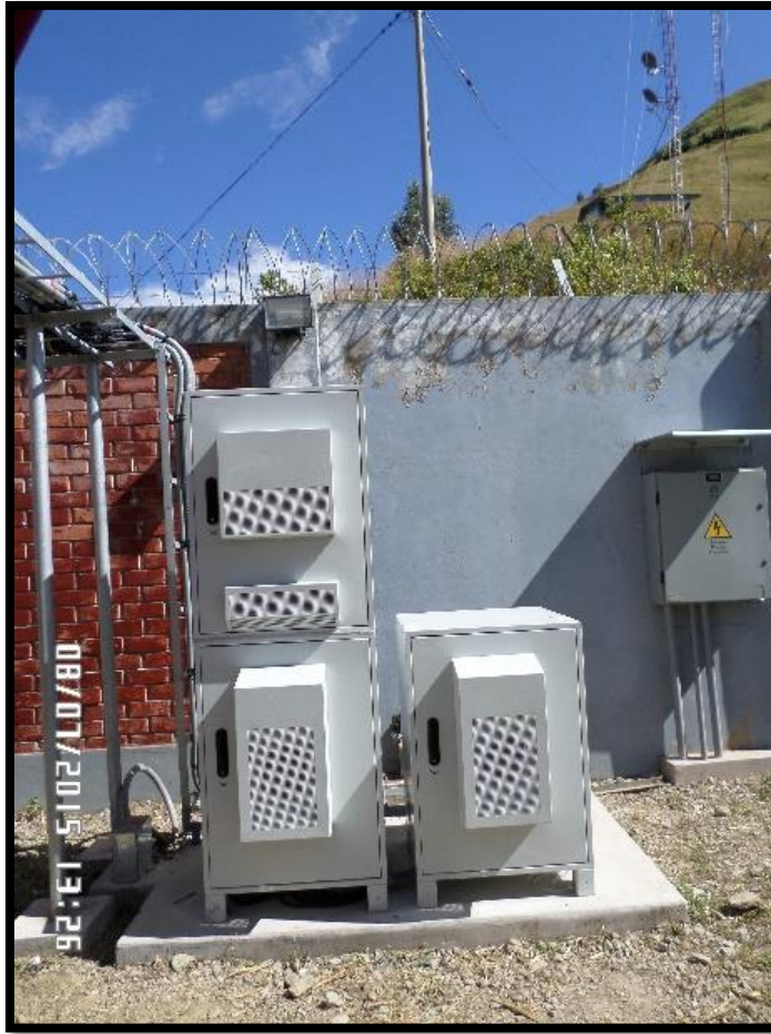
FIGURA 3-18: Foto actual de Gabinetes instalados en el Site Santa Teresa
