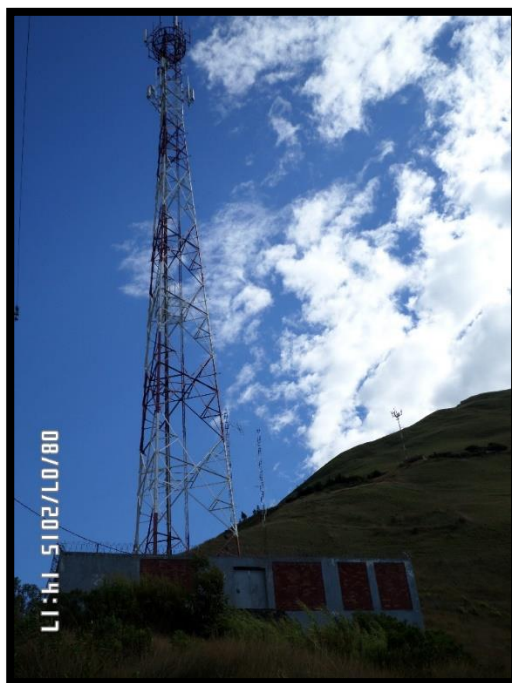
FIGURA 3-46: Torre del Site Santa Teresa
