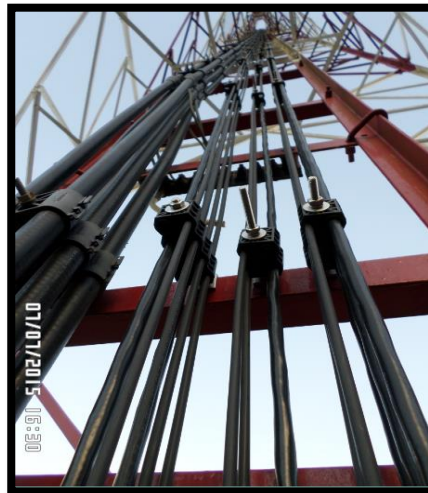
FIGURA 3-77: Clamp para cableado de F.O. y energía, Site Santa Teresa
