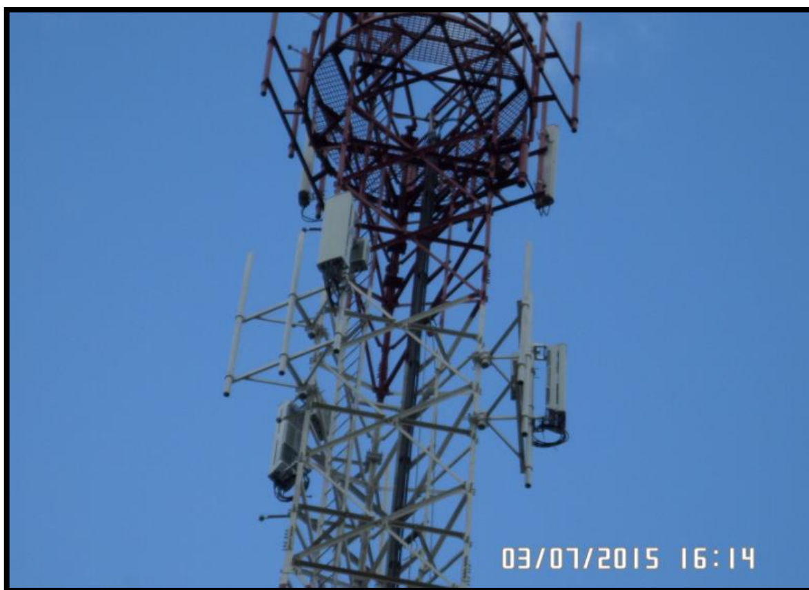
FIGURA 3-47: Antenas y RRU's instalados Back to Back del Site Santa Teresa en los 3 soportes
