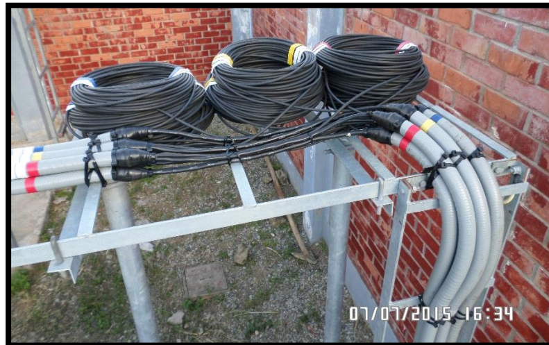
FIGURA 3-80: Excedente de Fibra Óptica, Site Santa Teresa
