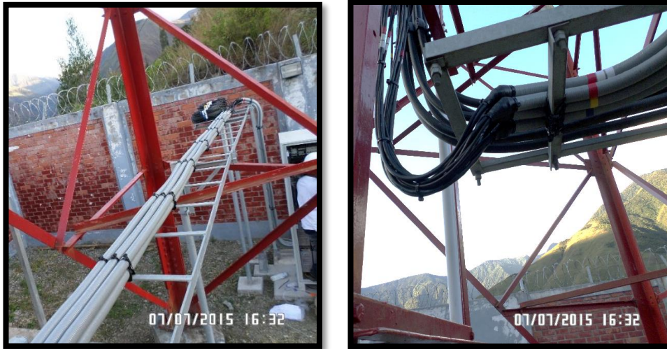
FIGURA 3-75: Cableado Horizontal, Site Santa Teresa
