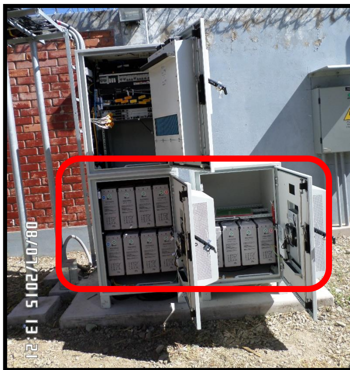
FIGURA 3-40: Banco de baterías, Site Santa Teresa
