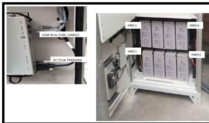
FIGURA 3-84: Etiquetado en la TCUA y Baterías, Site Santa Teresa
