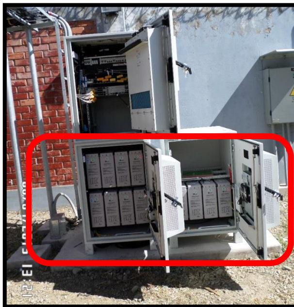
FIGURA 3-38: Banco de baterías en el site Santa Teresa
