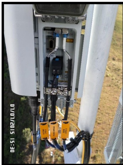
FIGURA 3-66: Posición conector pressfit en RRU, Site Santa Teresa
