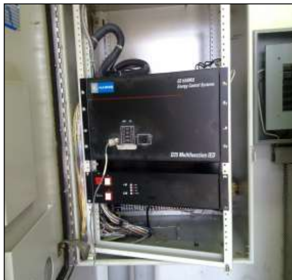
Fig. 6. Vista Frontal de RTU
