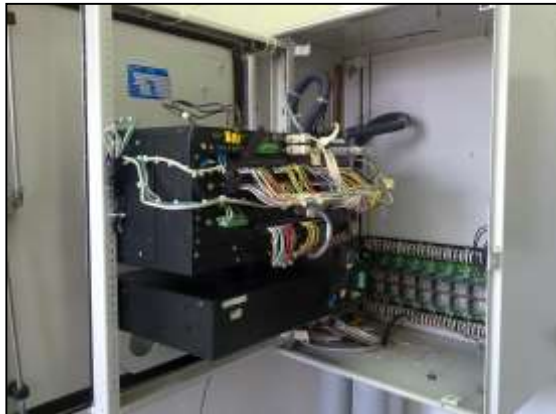
Fig. 7. Vista posterior de RTU
