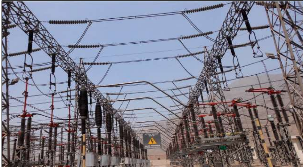
Fig. 3. Subestación de Transmisión Eléctrica
