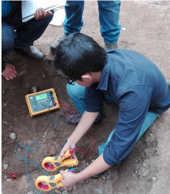
Figura 39. Mediciones pozo a tierra Fuente: Elaboración propia
