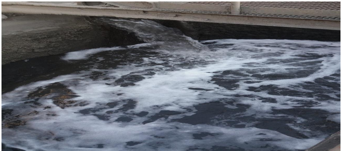
Figura 2.21. Tanque de agua de proceso Fuente: Elaboración propia
