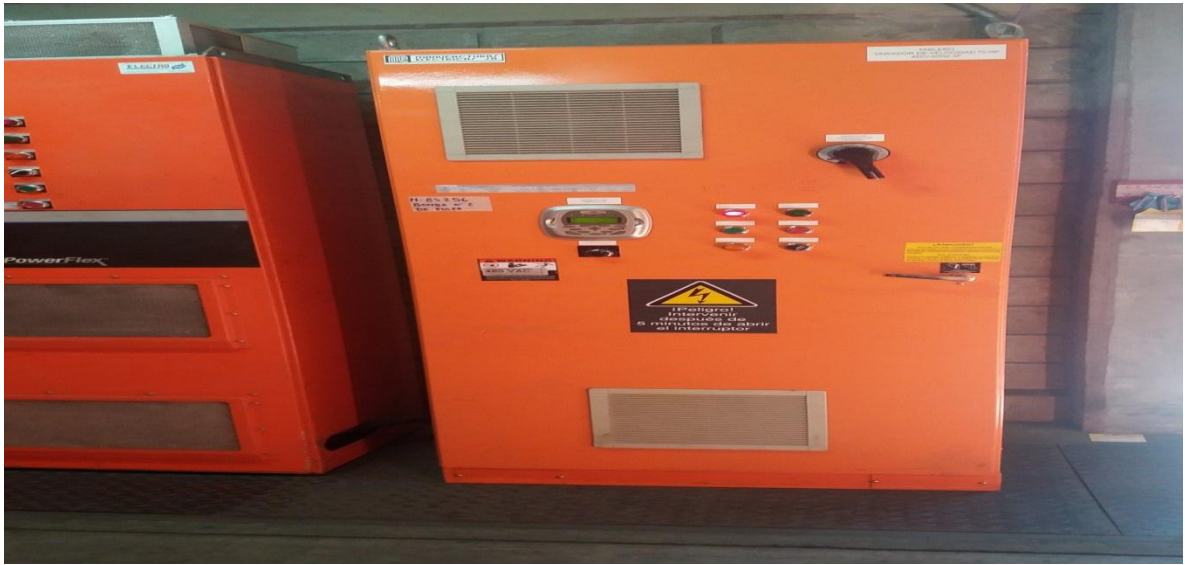
Figura 3.17. Arrancador instalado Fuente: elaboración propia
