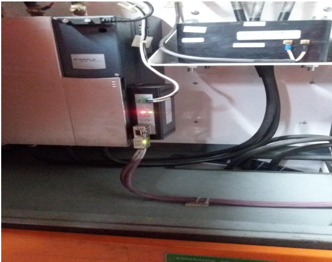
Figura 3.19. Equipo con último nodo de la red profibus Fuente: elaboración propia
