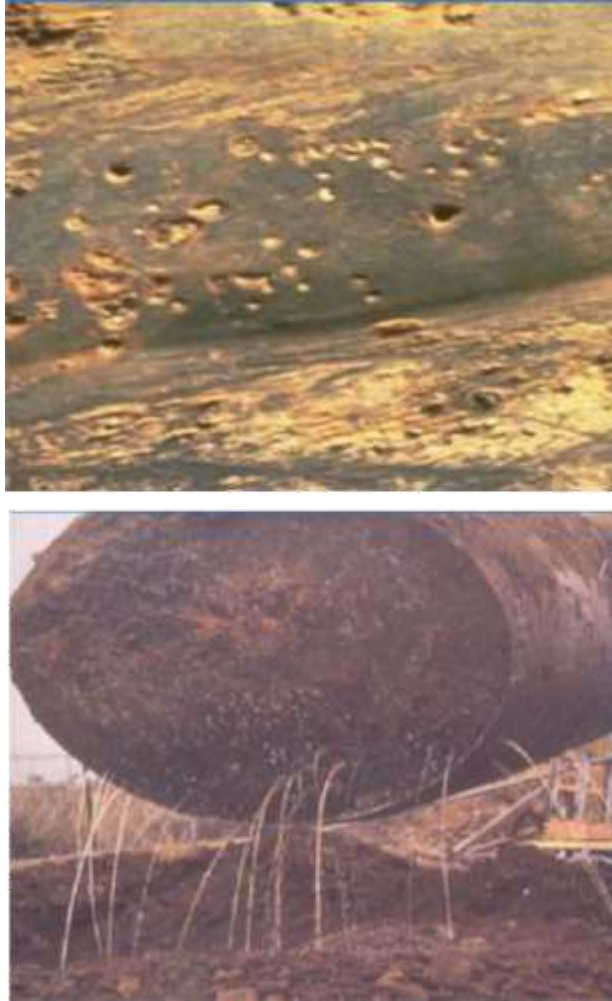
Figura 12. Daños por picaduras localizados.
