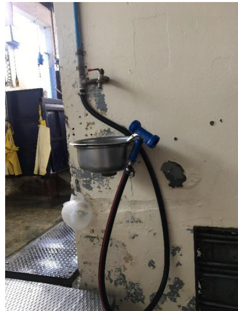
Figura 14. Punto de agua en faena vacuno. Fuente: ECSAC
