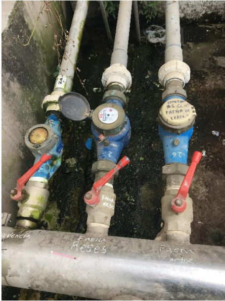
Descripción: Medidores de flujo de agua.
