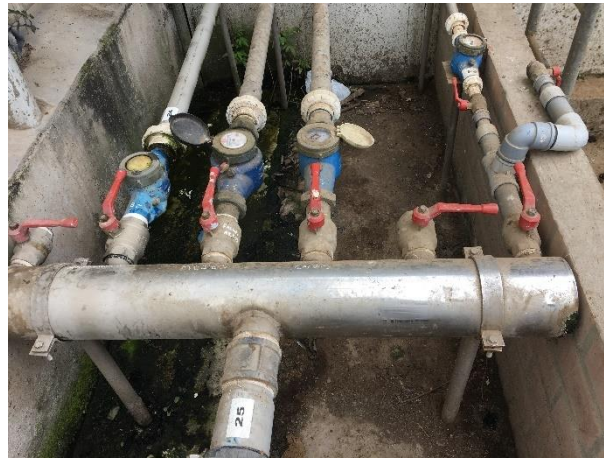
Figura 18. Medidores de flujos de agua. Fuente: ECSAC
