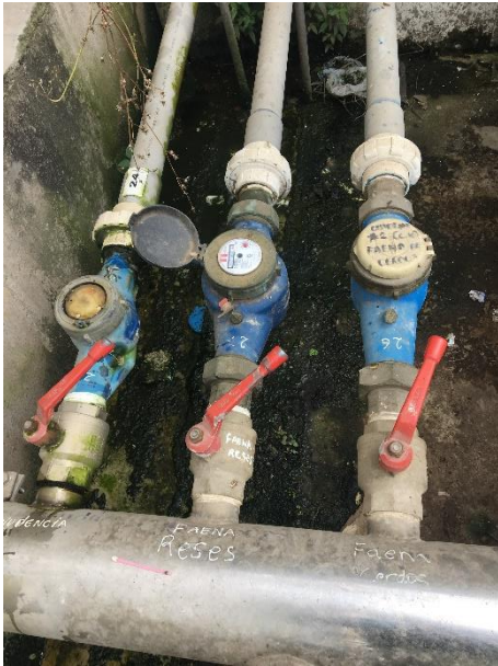
Descripción: Medidores de flujo de agua.
