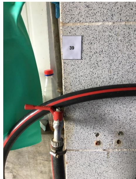
Descripción: Punto de agua, manguera, Faena Porcino.
