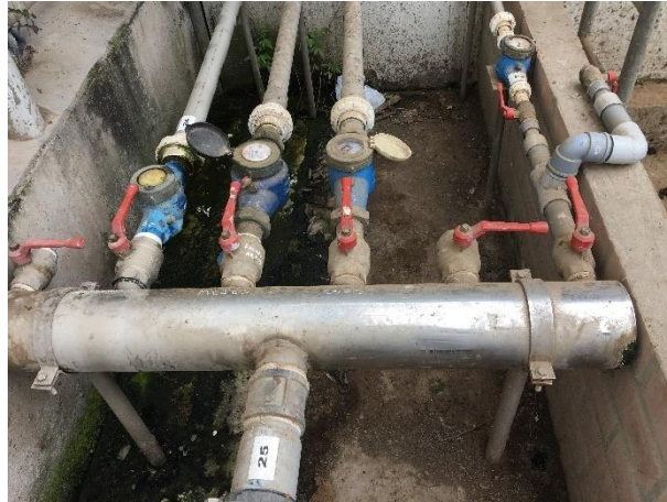
Figura 18. Medidores de flujos de agua. Fuente: ECSAC
