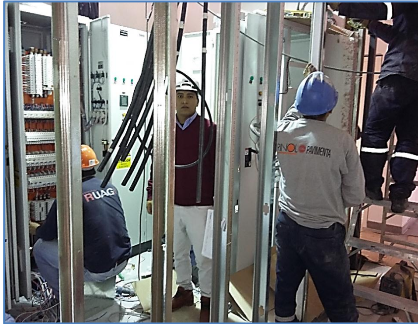
Figura 57: Instalación de tableros eléctricos en la tienda H&M Fuente: Elaboración Propia – BRANCH S.A.C
