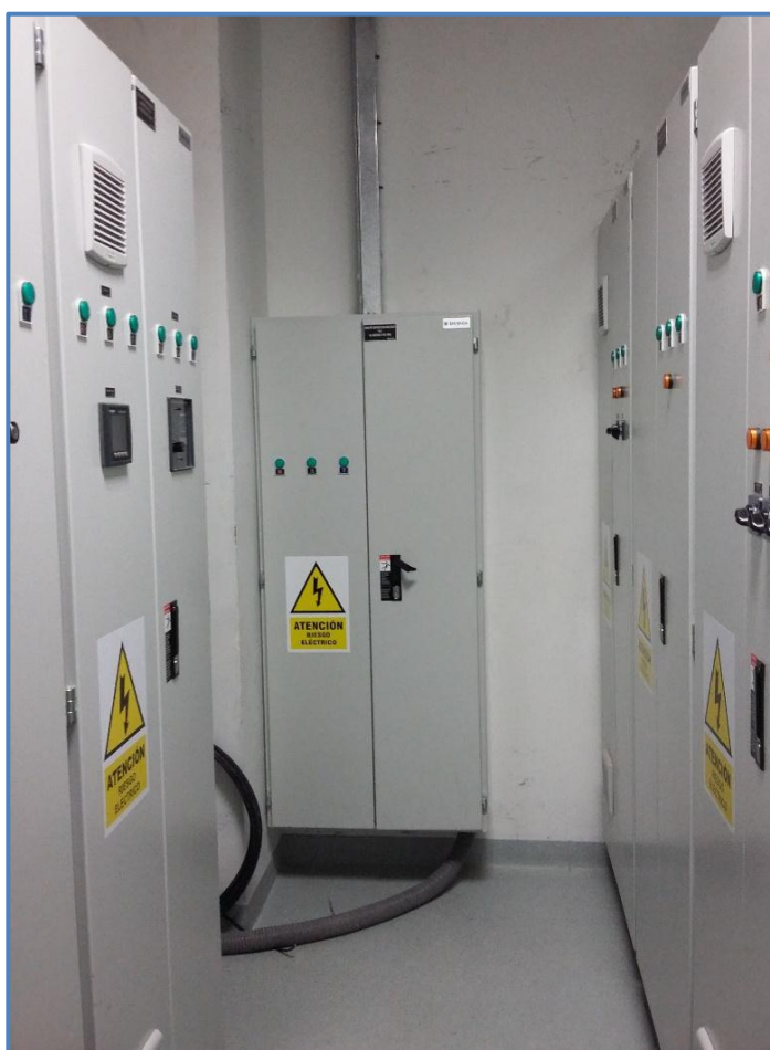
Figura 6: Sala Eléctrica 1 Fuente: Elaboración Propia – BRANCH S.A.C
