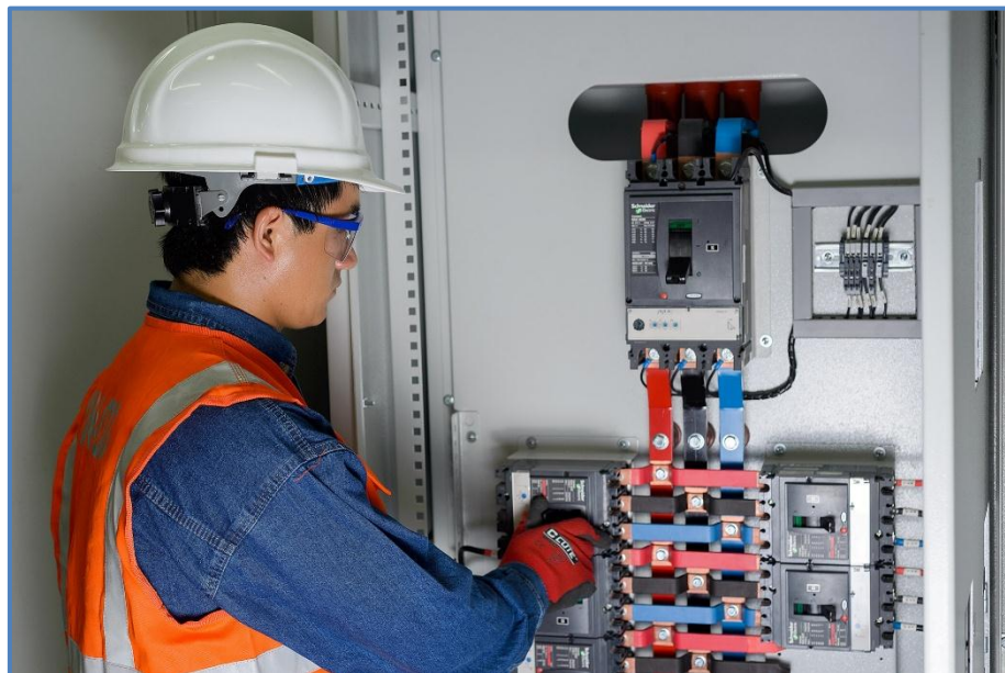
Figura 4: Interior de un Tablero Autosoportado. Fuente: Técnica Ingenieros S.R.L.
