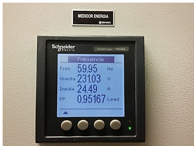
Figura 63: Vista de parámetros eléctricos del medidor de energía Fuente: Elaboración Propia – BRANCH S.A.C
