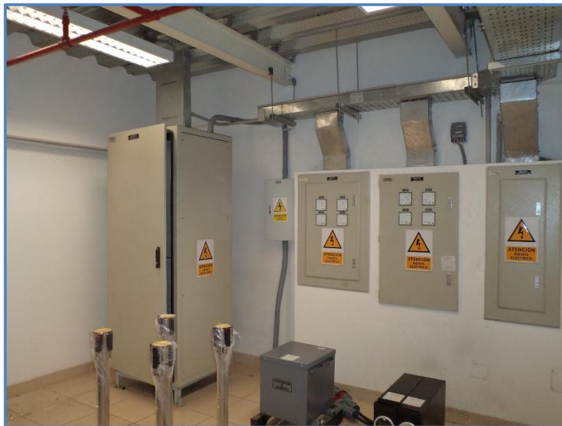
Figura 7: Sala Eléctrica 2 Fuente: Elaboración Propia – BRANCH S.A.C
