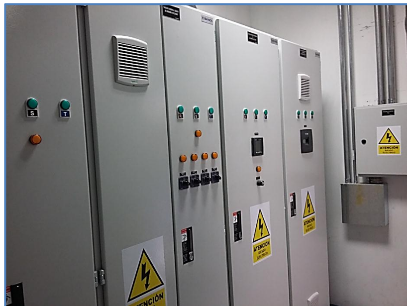
Figura 59: Sala eléctrica de la tienda H&M – Vista 2 Fuente: Elaboración Propia – BRANCH S.A.C
