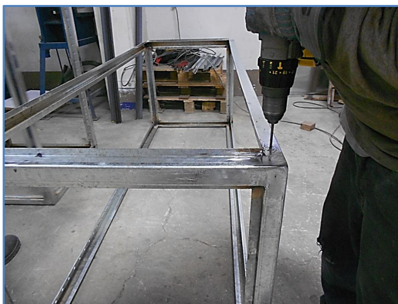
Figura 39: Perforado del marco de un tablero eléctrico para acoplar puerta Fuente: Elaboración Propia – BRANCH S.A.C
