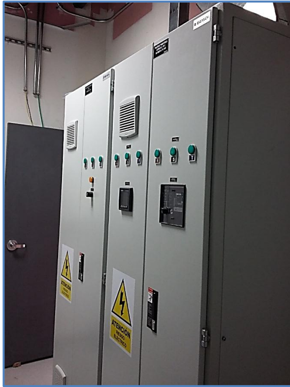
Figura 60: Sala eléctrica de la tienda H&M – Vista 3 Fuente: Elaboración Propia – BRANCH S.A.C
