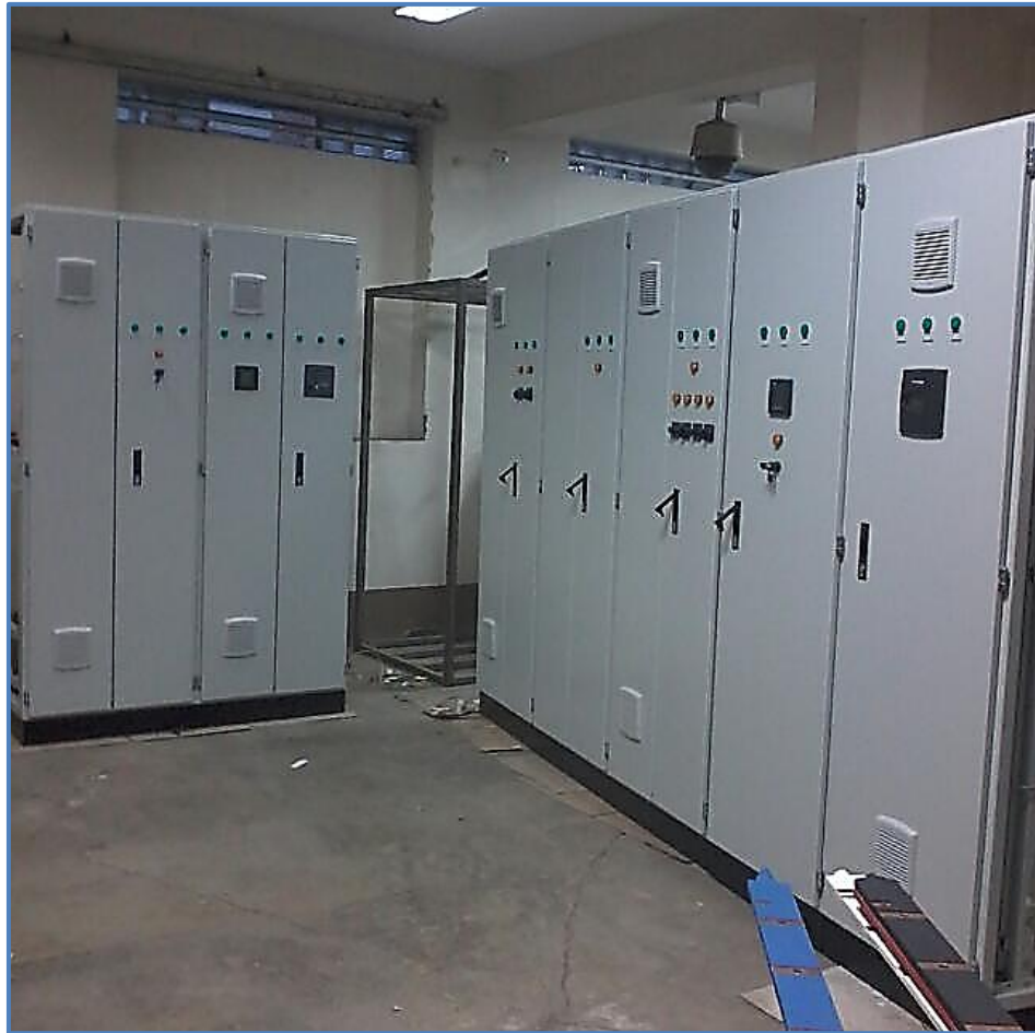
Figura 55: Tableros eléctricos Completamente terminados para H&M Fuente: Elaboración Propia – BRANCH S.A.C
