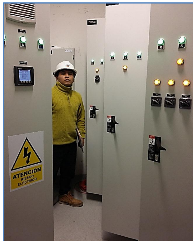
Figura 62: Puesta en marcha de tableros eléctricos - H&M Fuente: Elaboración Propia – BRANCH S.A.C
