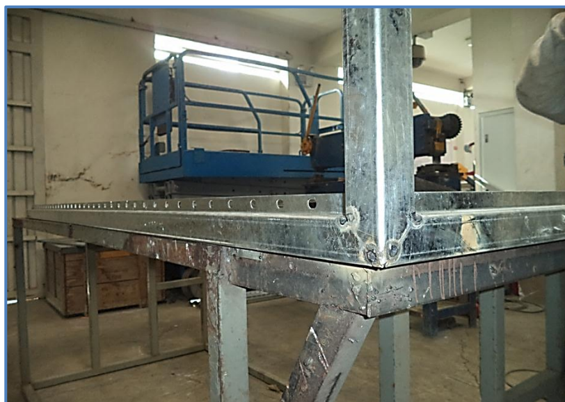
Figura 35: Vista de puntos de soldadura de 3 perfiles estructurales Fuente: Elaboración Propia – BRANCH S.A.C
