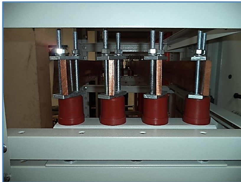
Figura 51: Barras de Cu de 1100A y Aisladores de soporte Fuente: Elaboración Propia – BRANCH S.A.C
