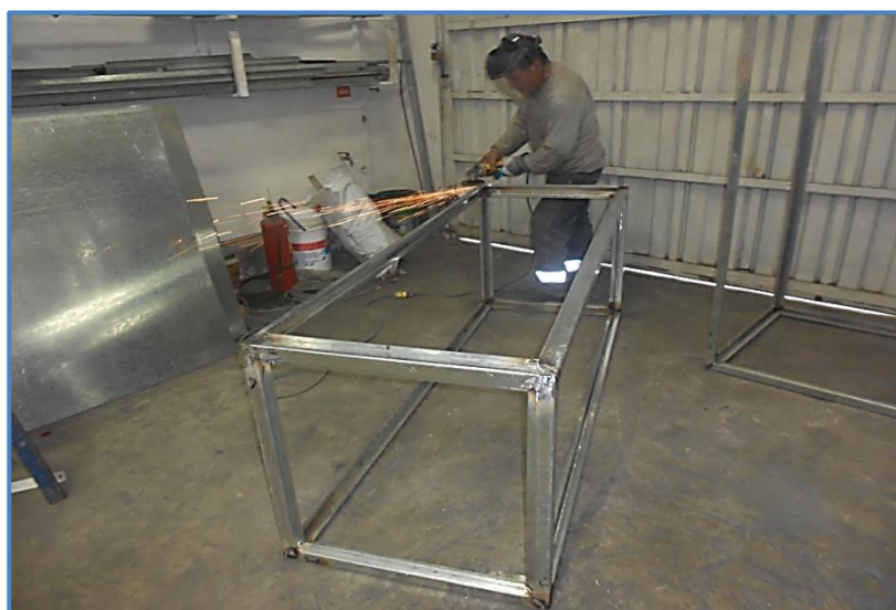
Figura 37: Esmerilado en las partes soldadas de un tablero eléctrico Fuente: Elaboración Propia – BRANCH S.A.C
