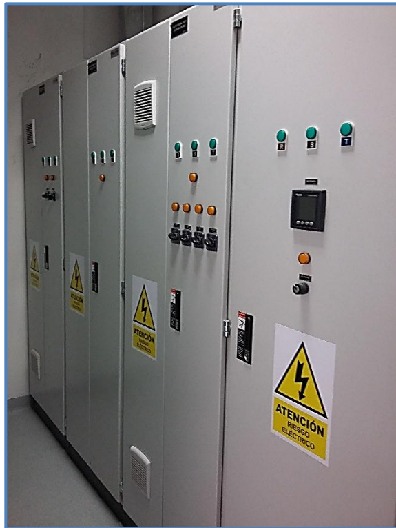
Figura 58: Sala eléctrica de la tienda H&M – Vista 1 Fuente: Elaboración Propia – BRANCH S.A.C
