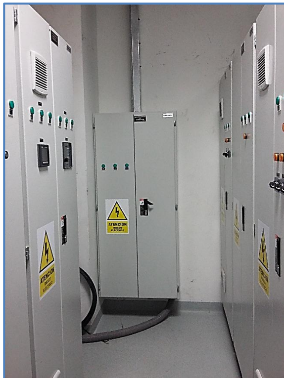
Figura 61: Sala eléctrica de la tienda H&M – Vista 4 Fuente: Elaboración Propia – BRANCH S.A.C
