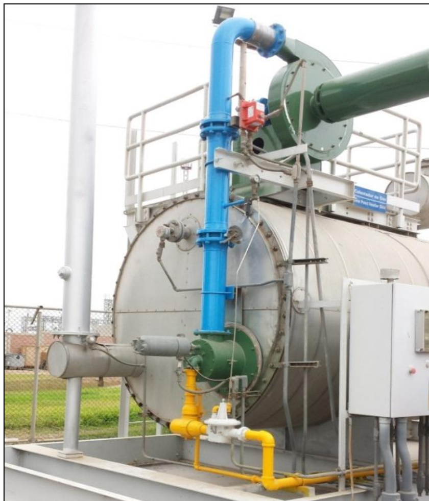
FIGURA 16 - CALENTADOR DE GAS YARD I
