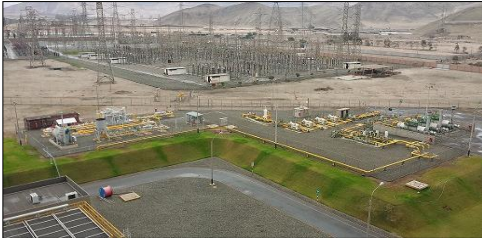
FIGURA 01 - VISTA PANORÁMICA DE LA ERM DE GAS NATURAL
