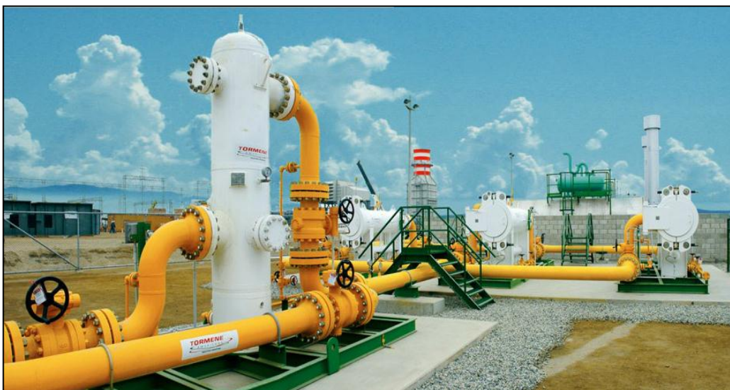
FIGURA 08 – ZONA DE FILTRADO DE LA ERM
