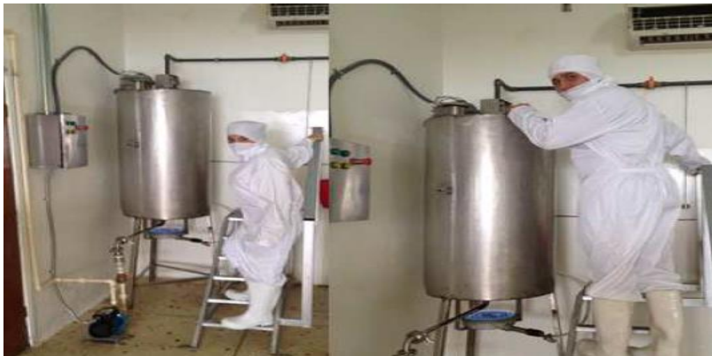
FIGURA 2. Equipo automatizado de tratamiento de agua para su posterior embotellamiento.
