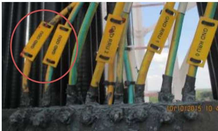
Figura 3.41: Aterramiento a la escalerilla rack de torre.
