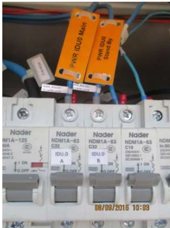
Figura 3.13: Ubicación de los breakers.
