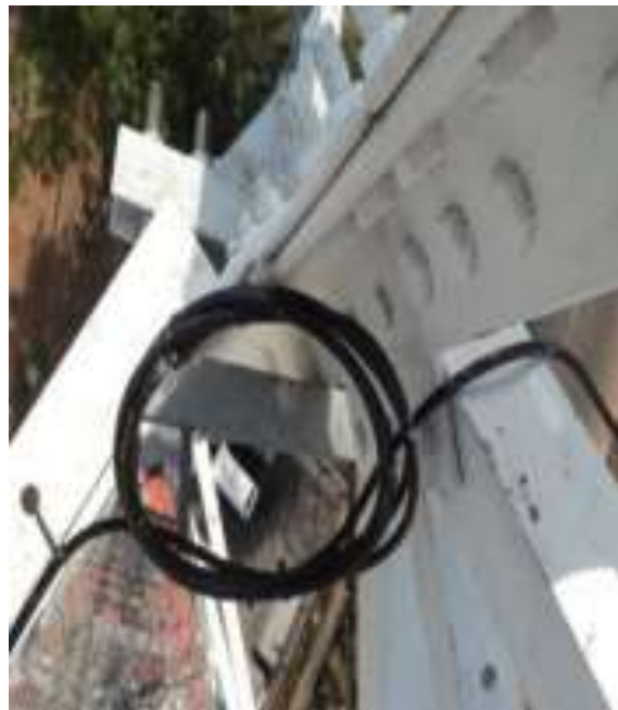
Figura 3.12: Cableado vertical con cintillos y reserva de cable IF en Torre.
