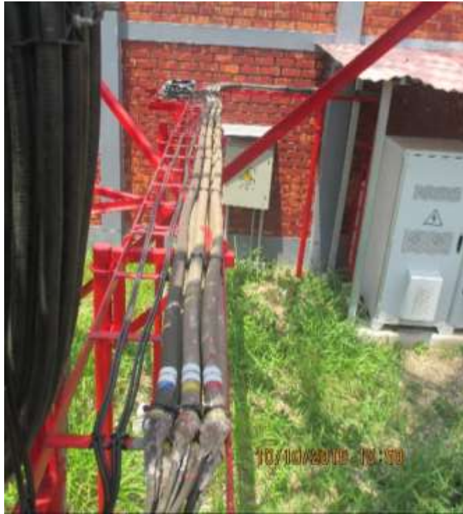
Figura 3.10: Cableado IF en escalerilla Outdoor.
