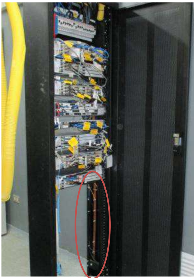
Figura 3.28: Barra de Tierra Interna.
