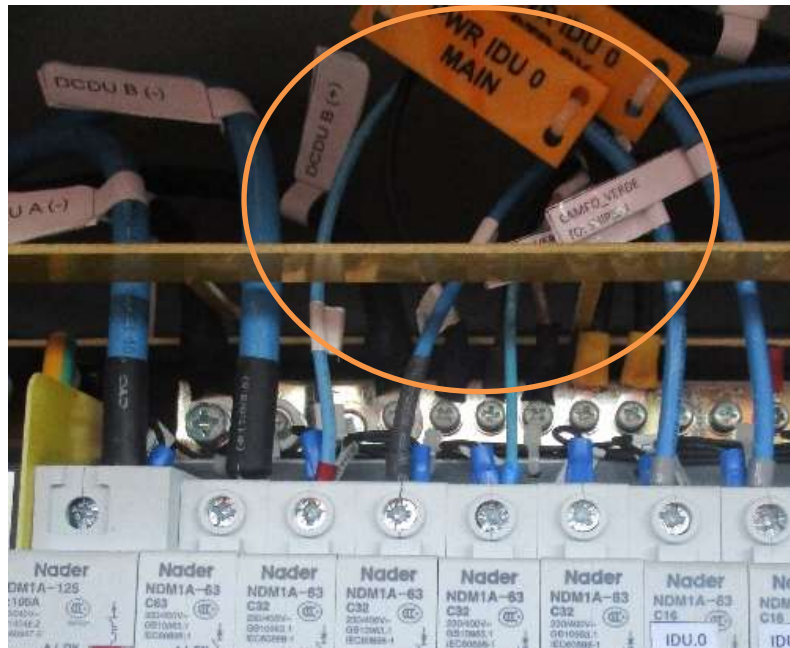
Figura 3.18: Etiqueta de Breaker a IDU 0 (MAIN).
