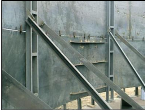
Ilustración 38 - Colocación de Cartelas y aseguramiento de la luz en la junta vertical
