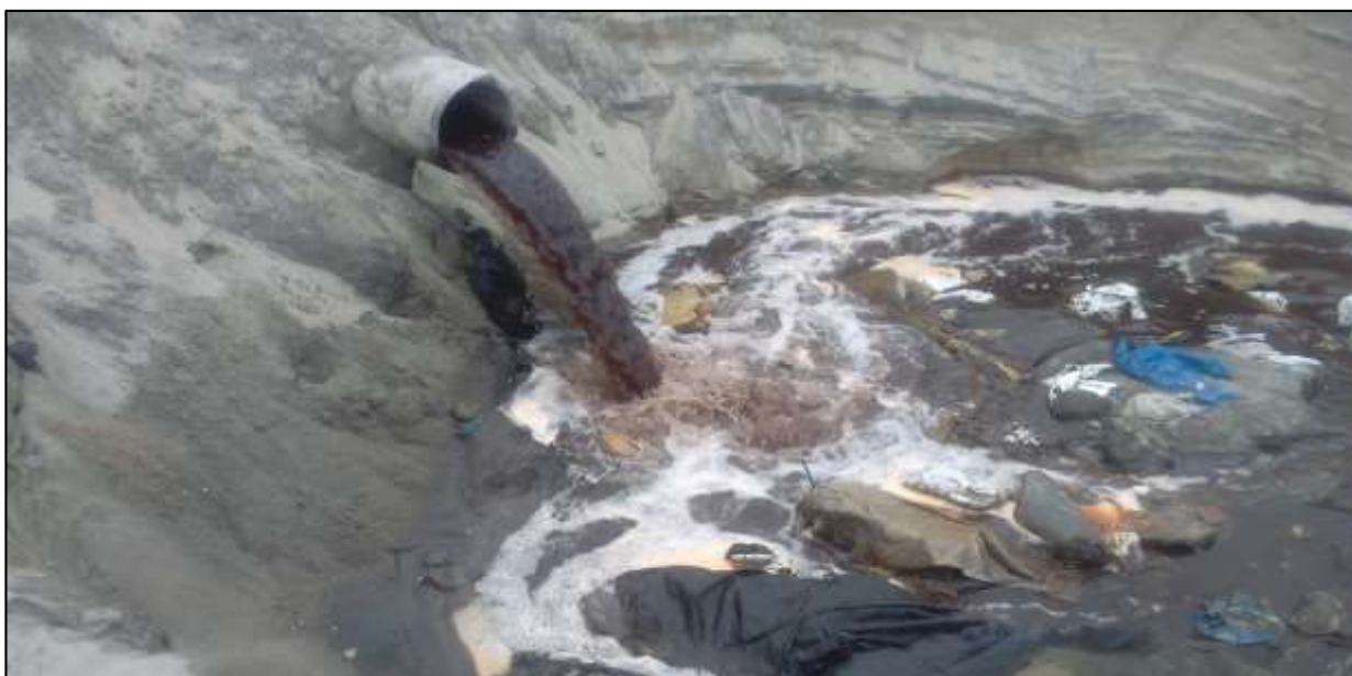
Tubería de rebose, de 10" de diámetro aproximadamente. Se evidencia una coloración marrón de las aguas, emanación de olores nauseabundos y presencia de excretas.
