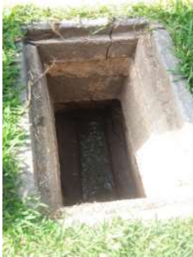
Figura 17. Caja de registro de aguas residuales.
