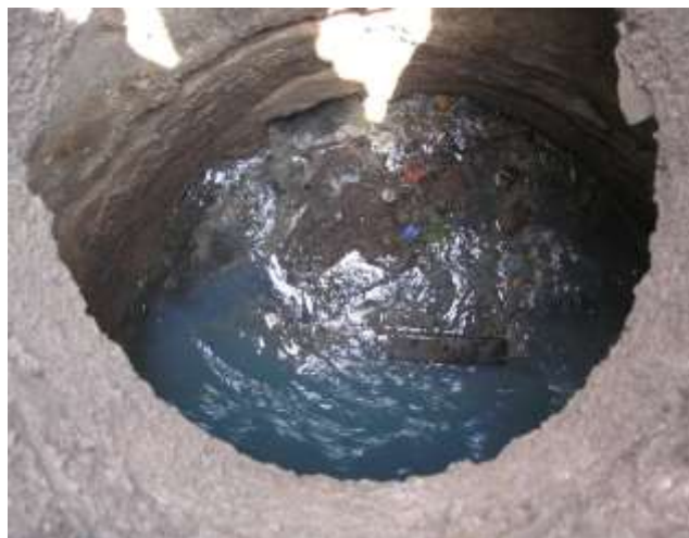
Figura 1. Obstrucciones en la red de alcantarillado.
