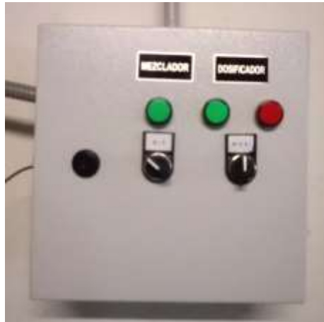
Figura 13. Tablero eléctrico de control.
