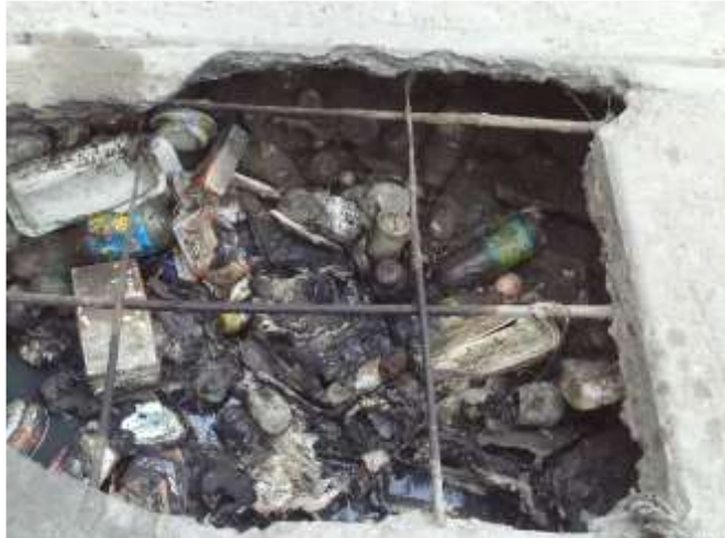
Figura 2. Obstrucciones por residuos sólidos.
