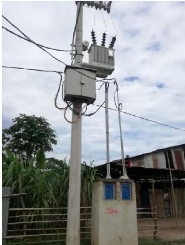
Figura N°6: Subestación Aérea Monoposte.
