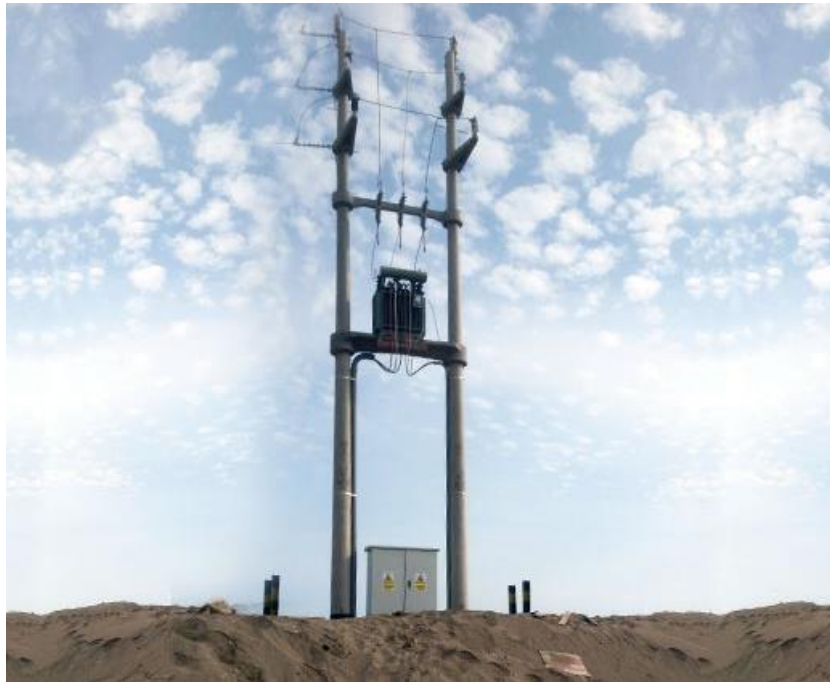
Figura N°7: Subestación Aérea Biposte,
