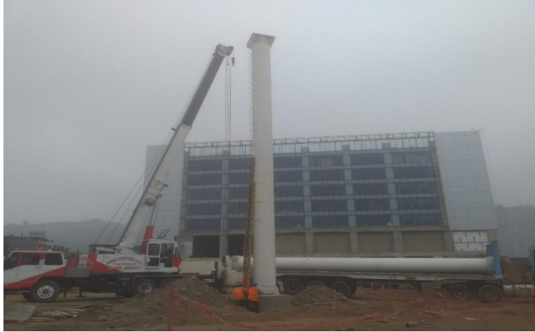
Figura 6. Posicionamiento de la Torre Unipolar Fuente: Propia
