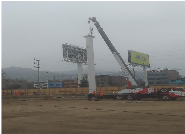
Figura 5. Descarga de la Torre Unipolar Fuente: Propia
