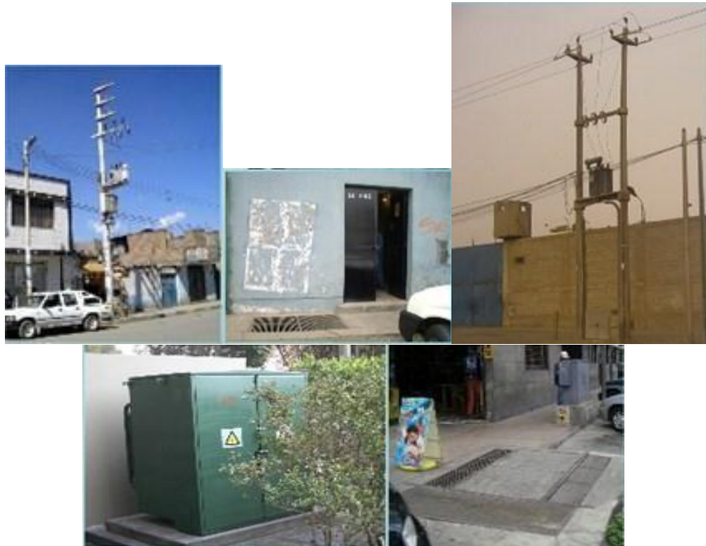
Figura 3. Subestaciones de Distribución (SED)
