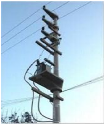
Figura 8. Media plataforma soportando a un Transformador de medición.
