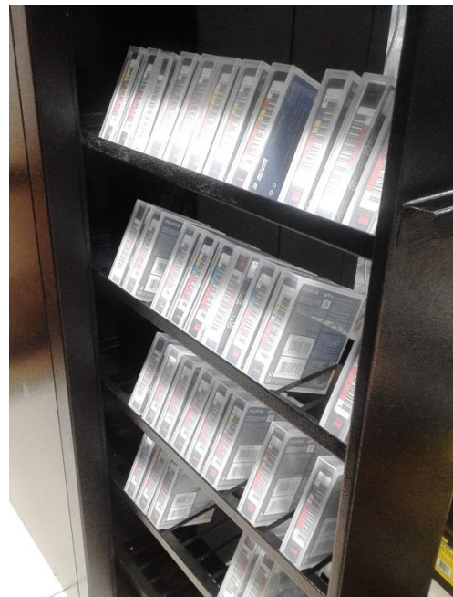
FIGURA 3 36:Cintas LTO en el rack FUENTE: Elaboración Propia
