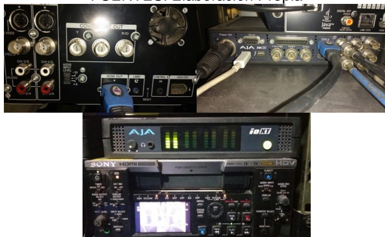
FIGURA 3 17: Conexiones de equipos FUENTES: Elaboración Propia
