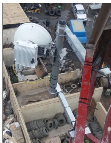
Figura 59: Soporte para torre autosportada, site CHOCOPE Fuente: Elaboración propia
