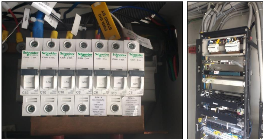
Figura 49: Ubicación de los breakers. Fuente: Elaboración propia
