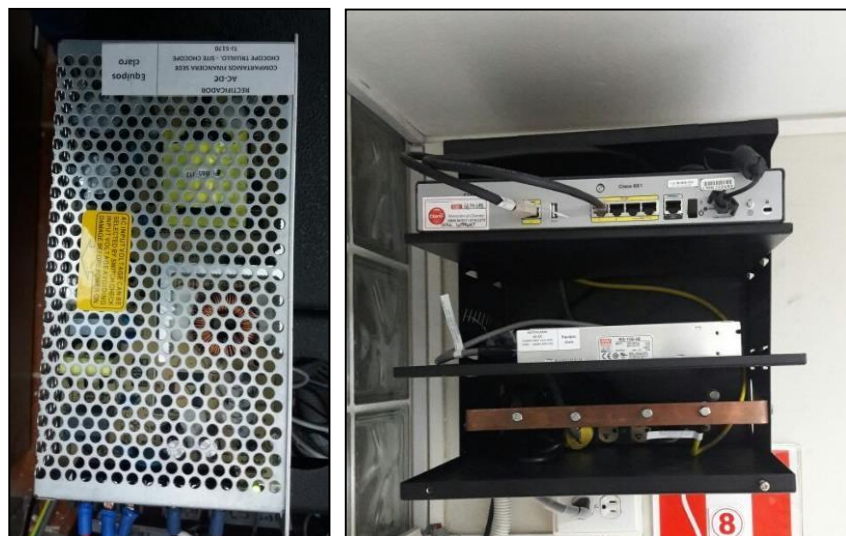
Figura 50: instalación de convertor. Fuente: Elaboración propia
