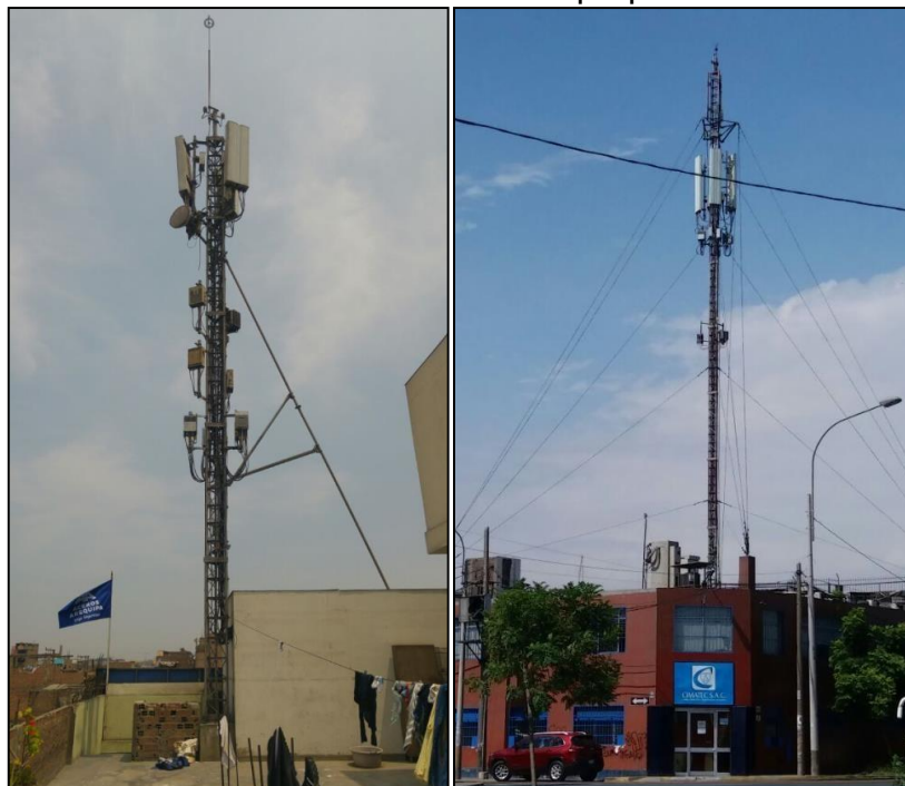
Figura 29: Torre arriostrada-ventada Fuente: Elaboración propia
