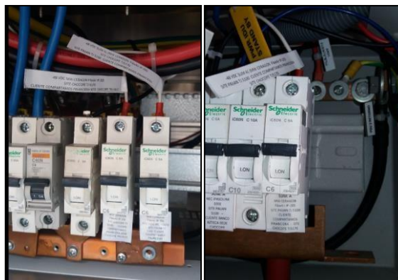
Figura 56: Etiquetado de Breaker que energiza la RFU Fuente: Elaboración propia.
