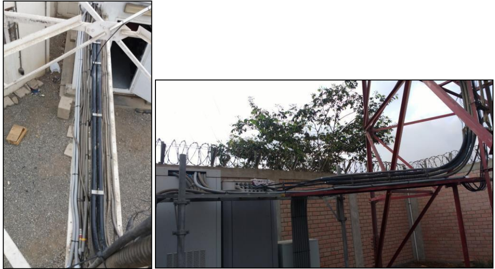
Figura 46: Cableado en escalerilla outdoor. Fuente: Elaboración propia
