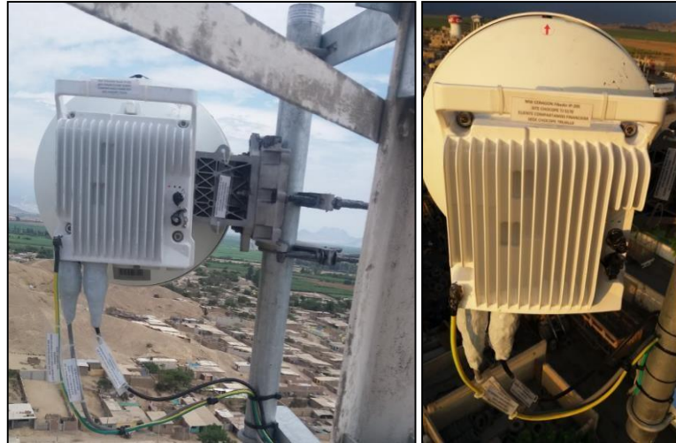
Figura 55: Etiquetado general de la RFU. Fuente: Elaboración propia.
