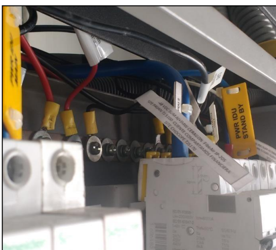
Figura 57: Etiquetado del energizado en la barra positiva de gabinete. Fuente: Elaboración propia.
