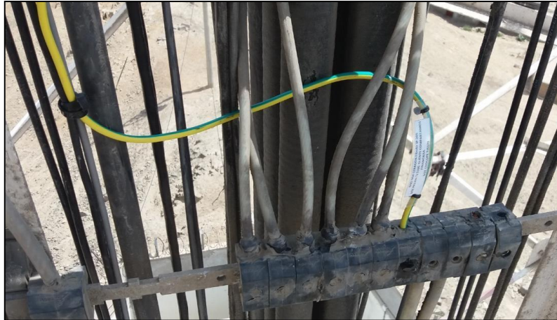
Figura 65: Aterramiento de la RFU. Site PAIJAN Fuente: Elaboración propia.
