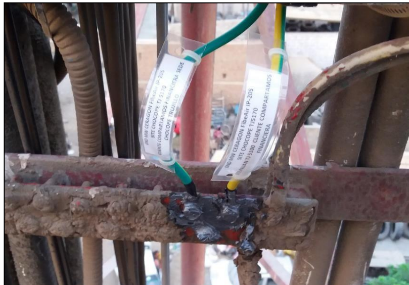
Figura 66: Aterramiento de la RFU. Site CHOCOPE. Fuente: Elaboración propia
