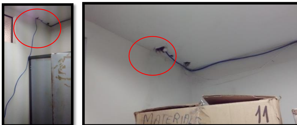
Figura 3.47: Cable de acceso al área de equipos (antes y después). Fuente: Elaboración propia.
