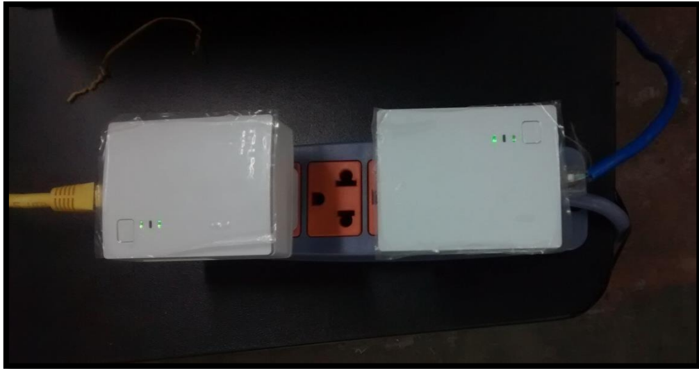
Figura 3.9: Conexión de adaptadores en una toma multi-contacto. Fuente: elaboración propia.
