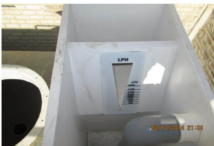
Figura 27: Medidor de Caudal
