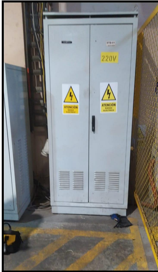
Figura 16. Tablero general 220 V en área de calidad en la planta industrial Celsa
