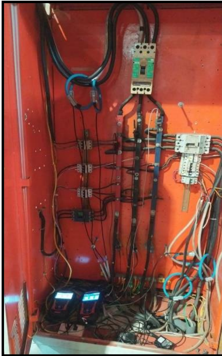
Figura 18. Conexión del Analizador de redes METREL POWER QUALITY ANALYSER PLUS – MI 2982
