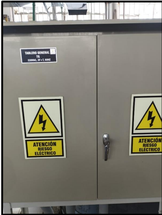
Nota: Tablero General de la empresa Tecnología en Grasas
