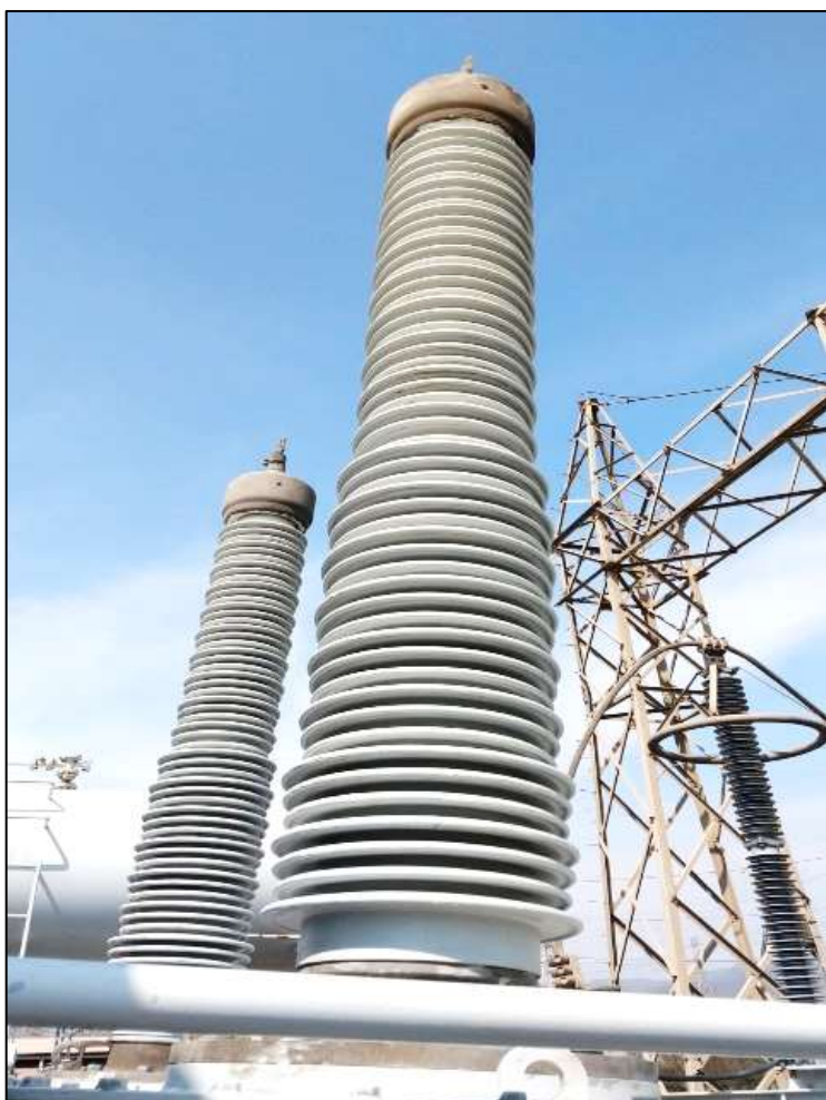
Figura 10: Bushing de 220KV del transformador de potencia.
