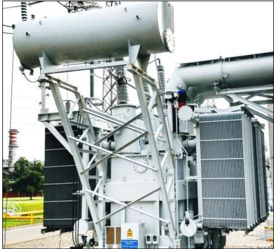
Figura 6: Tanque conservador del transformador de potencia, 2020.
