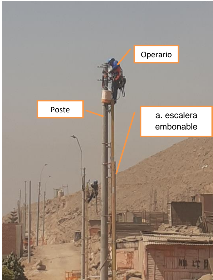
Escalamiento de poste
