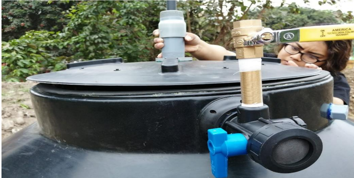
Revisión de las conexiones del biodigestor
