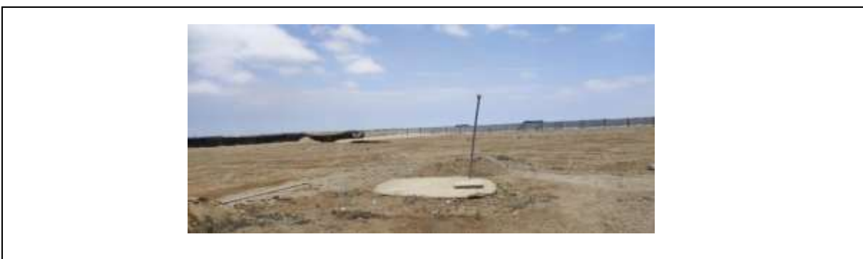
Pozo séptico de aguas residuales de la avícola AJI SECO SAC
