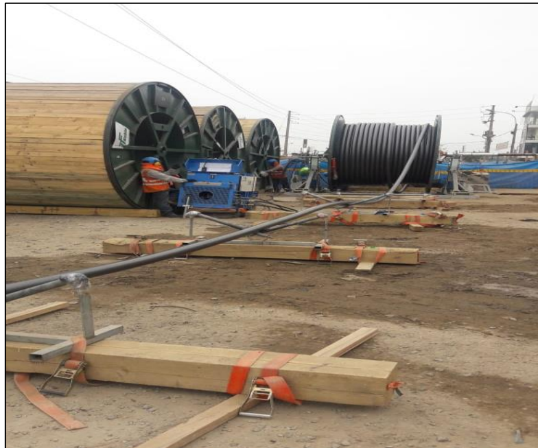
Figura 29. Instalación, de rodillos cuadrantes.
