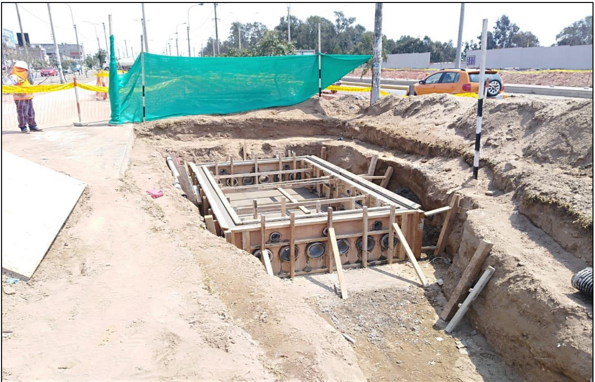
Figura 14. Cámara de Empalme.
