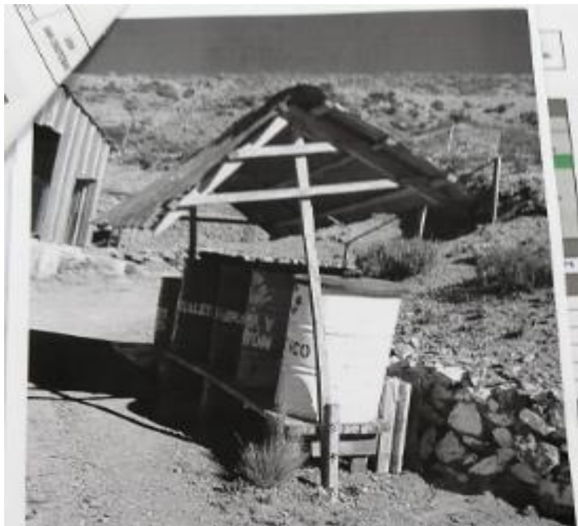
Figura 11. Módulo en mal estado
