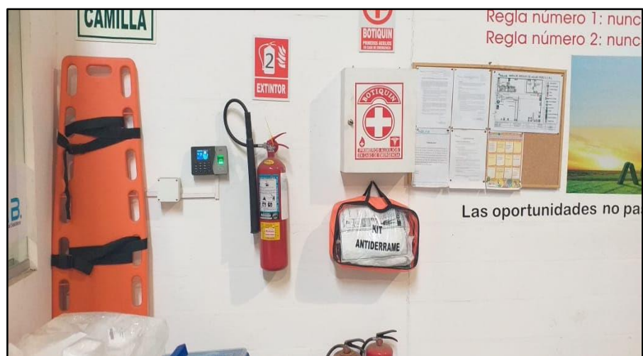
Figura 4: Equipos de emergencia
