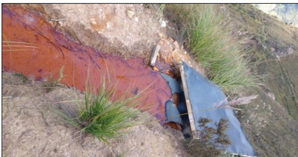
Figura 29: Drenaje ácido de mina de las filtraciones de las bocaminas de Azalia
