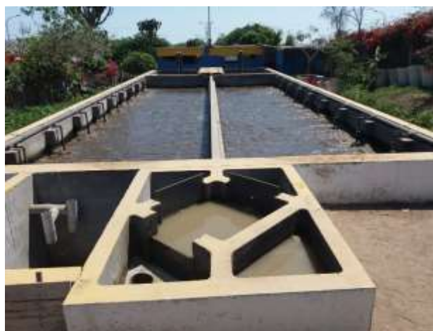
Descripción: Planta de tratamiento de aguas residuales domésticas de la Municipalidad de Villa el Salvador, tratamiento convencional - lodos activados.
