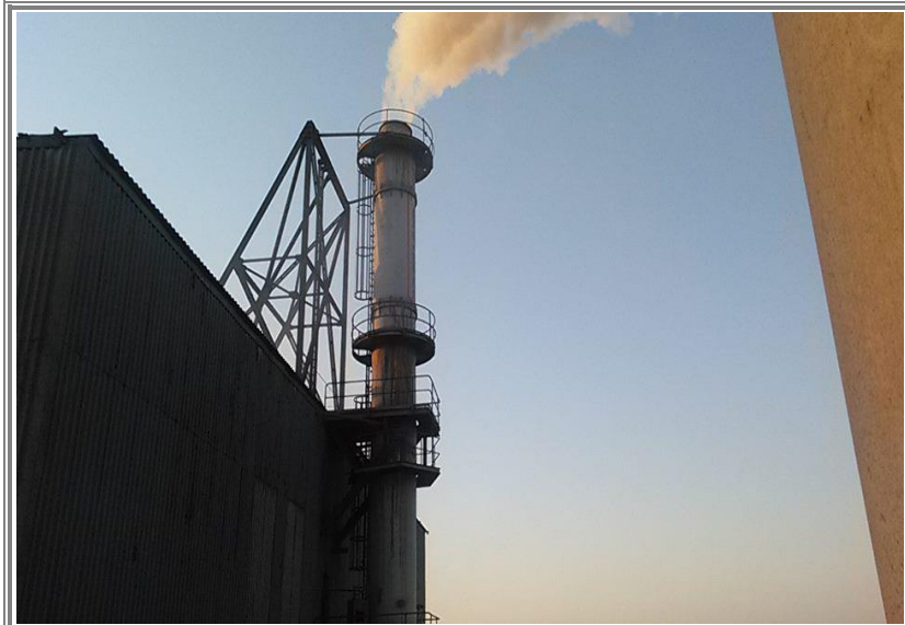
FOTO 01. CHIMENEA FUNDICION EN FUNCIONAMIENTO – VISTA INTERIOR DE PLANTA
