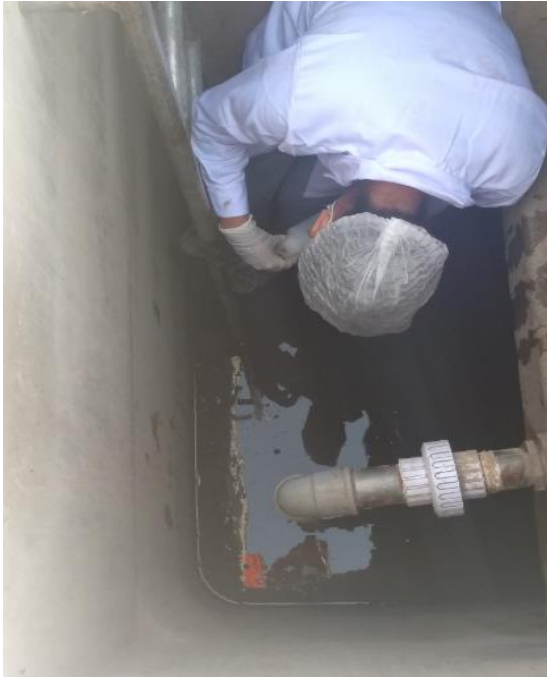
Figura 1. Cámara de bombeo
