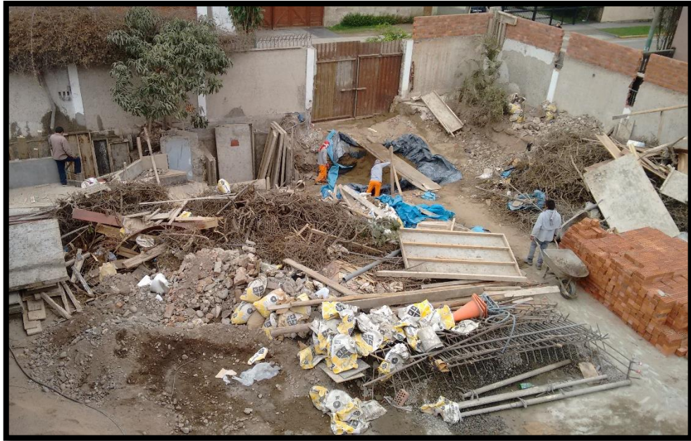
Anexo 1: Falta de orden y limpieza en área de trabajo (desmontes, cables mal ubicados)
