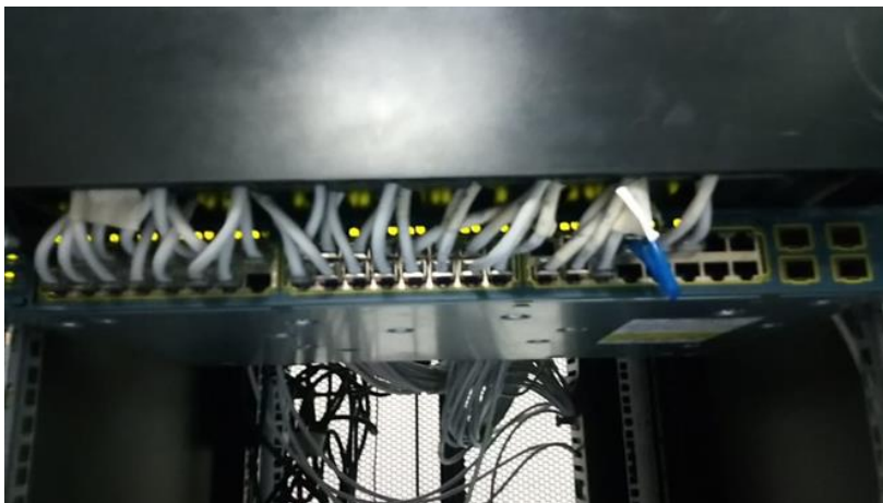
Figura 27 Switch Cisco para gestión de equipos.
