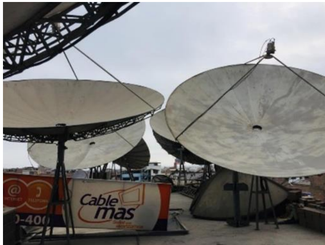
Figura 18 Patio de antenas de recepción en banda C.
