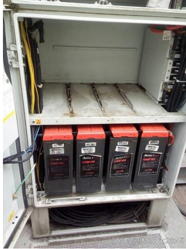
Figura 21: Banco de baterías Acme-F. Fuente: Elaboración propia
