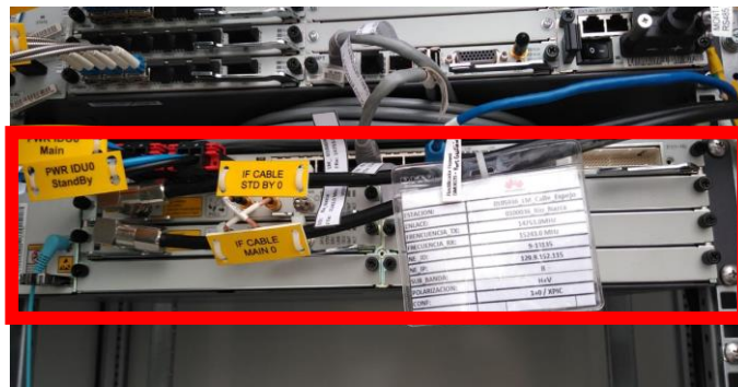
Figura 13: Radio RTN950 Huawei. Fuente: Elaboración propia
