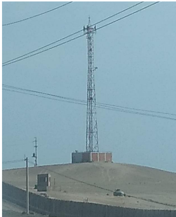
Figura 7: Tipo autoportada Fuente: Elaboración propia
