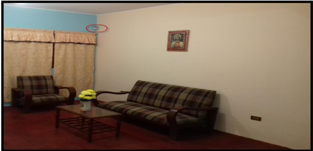
Figura 64: Instalación del Detector de Movimiento con el Dispositivo de Acondicionamiento de Señal
