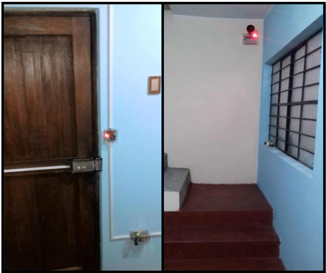
Figura 89: Validación de funcionamiento de alarma en el tercer escenario
