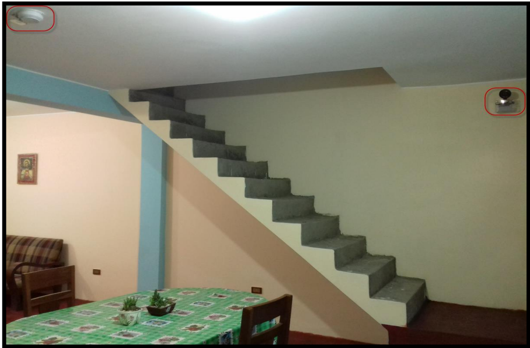
Figura 70: Instalación del Detector de Humo con el Dispositivo de Acondicionamiento de Señal
