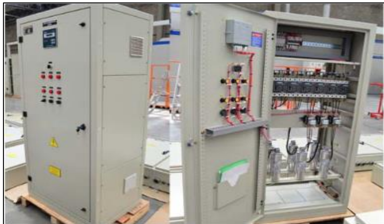
Figura 10 : Tablero de Banco de Condensadores Fuente: (INDUSTRIAS ECTRICOL, s.f.) [40]
