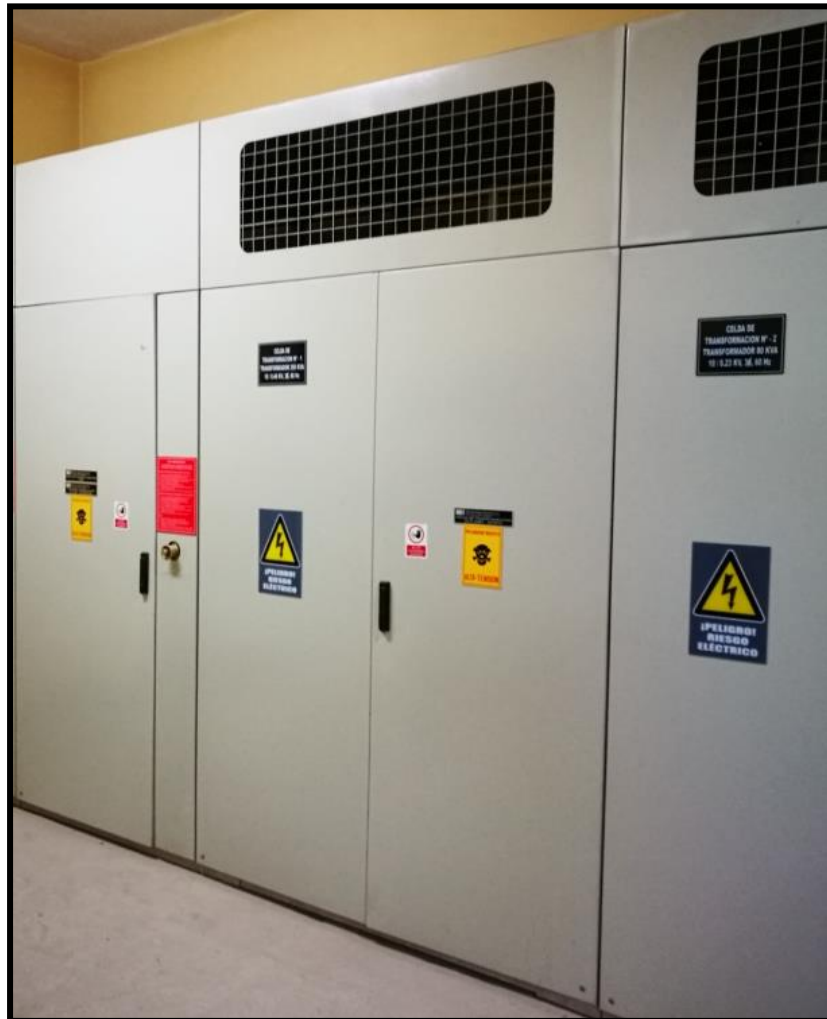
Figura N°10: Subestación eléctrica particular (SEP) Ancieta.
