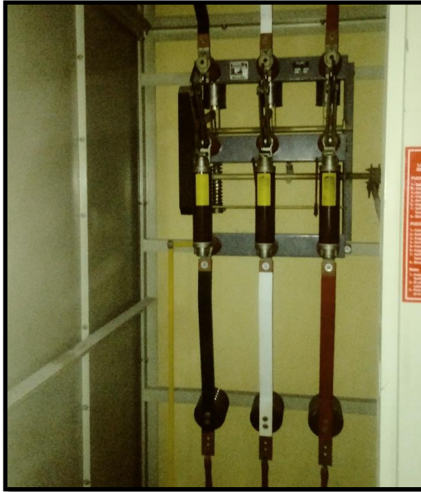
Figura N°6. Seccionador de Potencia y fusible tipo CEF.
