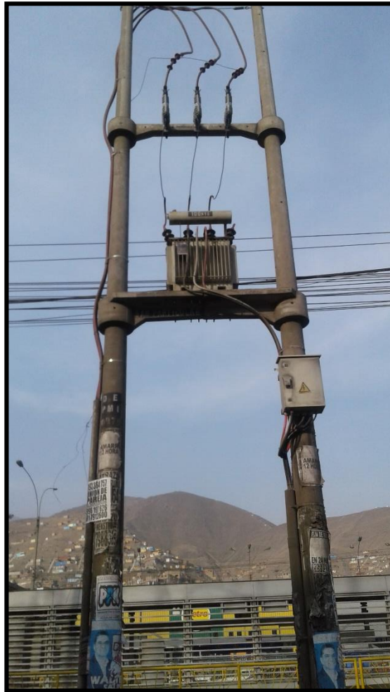
Figura N°2: Subestación Aérea Biposte (SAB)
