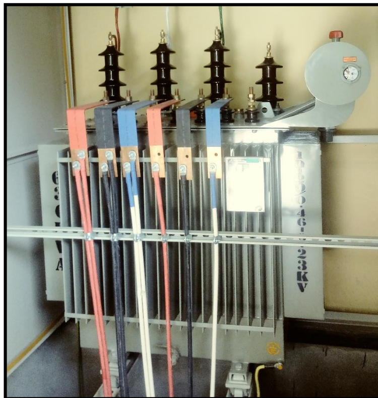
Figura N°5. Transformador de Potencia.
