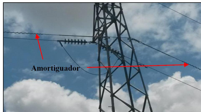
Figura 31. Amortiguadores en torres.
