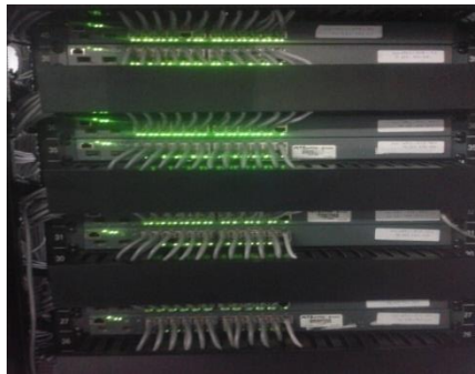
Figura 36. Switches Elaboración propia
