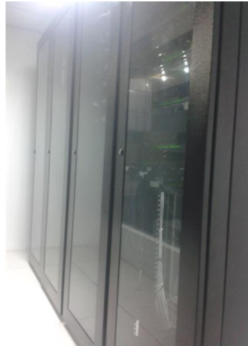
Figura 6. Cuarto de telecomunicaciones
