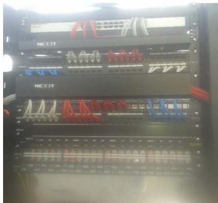
Figura 49. Patch cord en el cuarto de cableado
