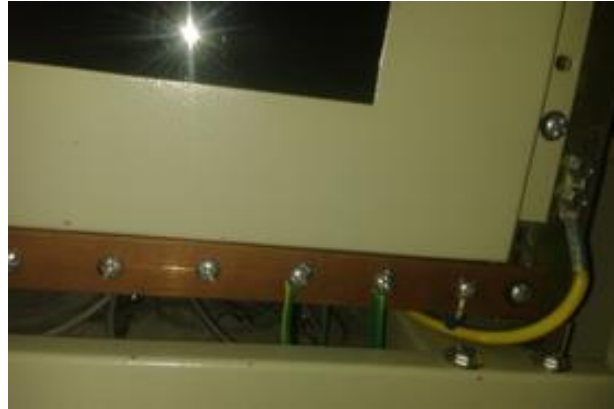
Figura 38. Conexión del rack a la barra de tierra Elaboración propia
