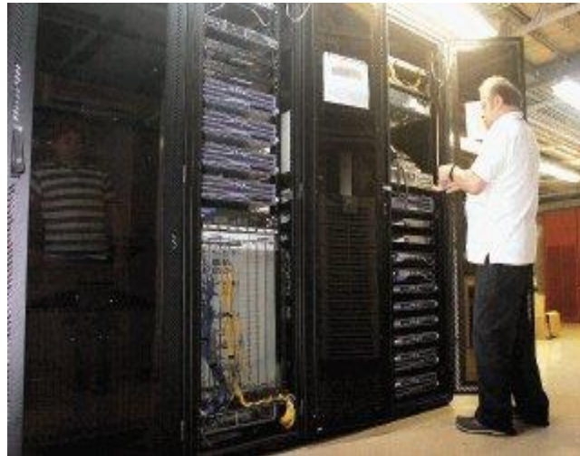
Figura 7. Cuarto de equipos
