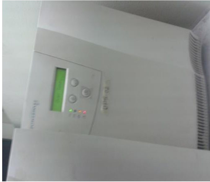
Figura 39. UPS Elaboración propia
