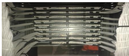
Figura 35. Patch panels en el rack
