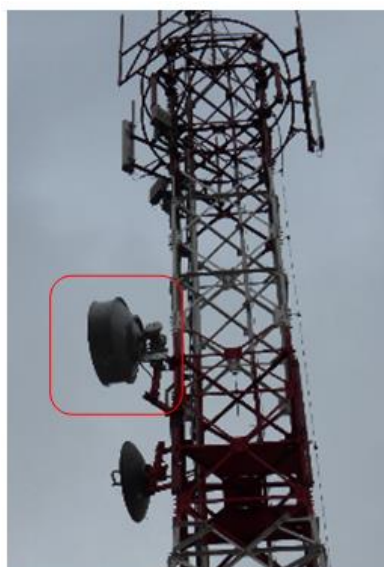
Figura 21 - Antena existente y Antena Nueva.
