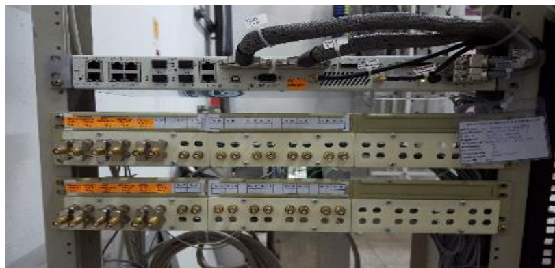
Figura 27 - Equipo ALCplus2e (IDU) y Regletas DDFs nuevos instalados.
