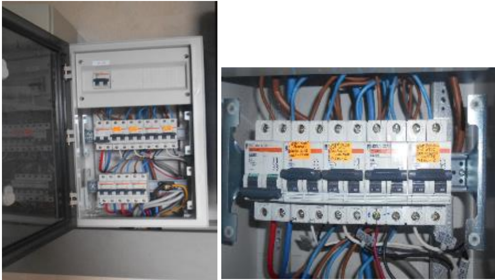
Figura 34 - Breaker En Gabinete De Energía.
