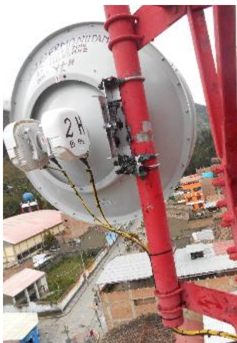
Figura 22 - Antena, ODU's, Acoplador instalado y cableado.
