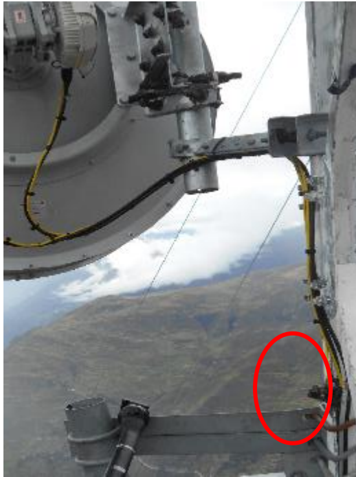
Figura 32 - Aterramiento de ODUs en torre.
