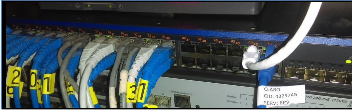
Figura 3.13: Switch Juniper EX2200 Fuente: Elaboracion propia
